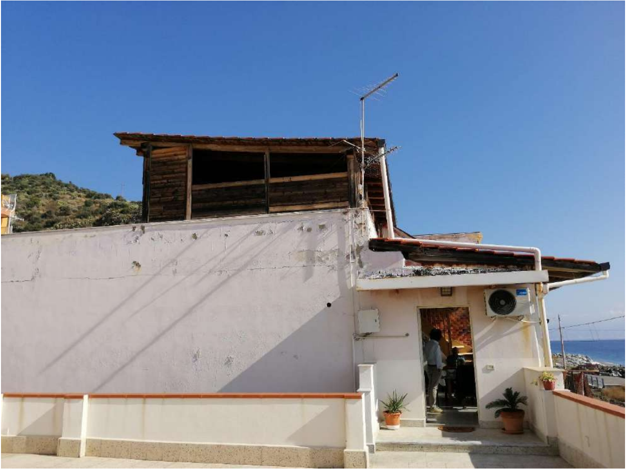
Foto n°73 Da questa foto si nota la diversa impostazione della falda di copertura della tettoia e le parziali chiusure laterali della stessa
