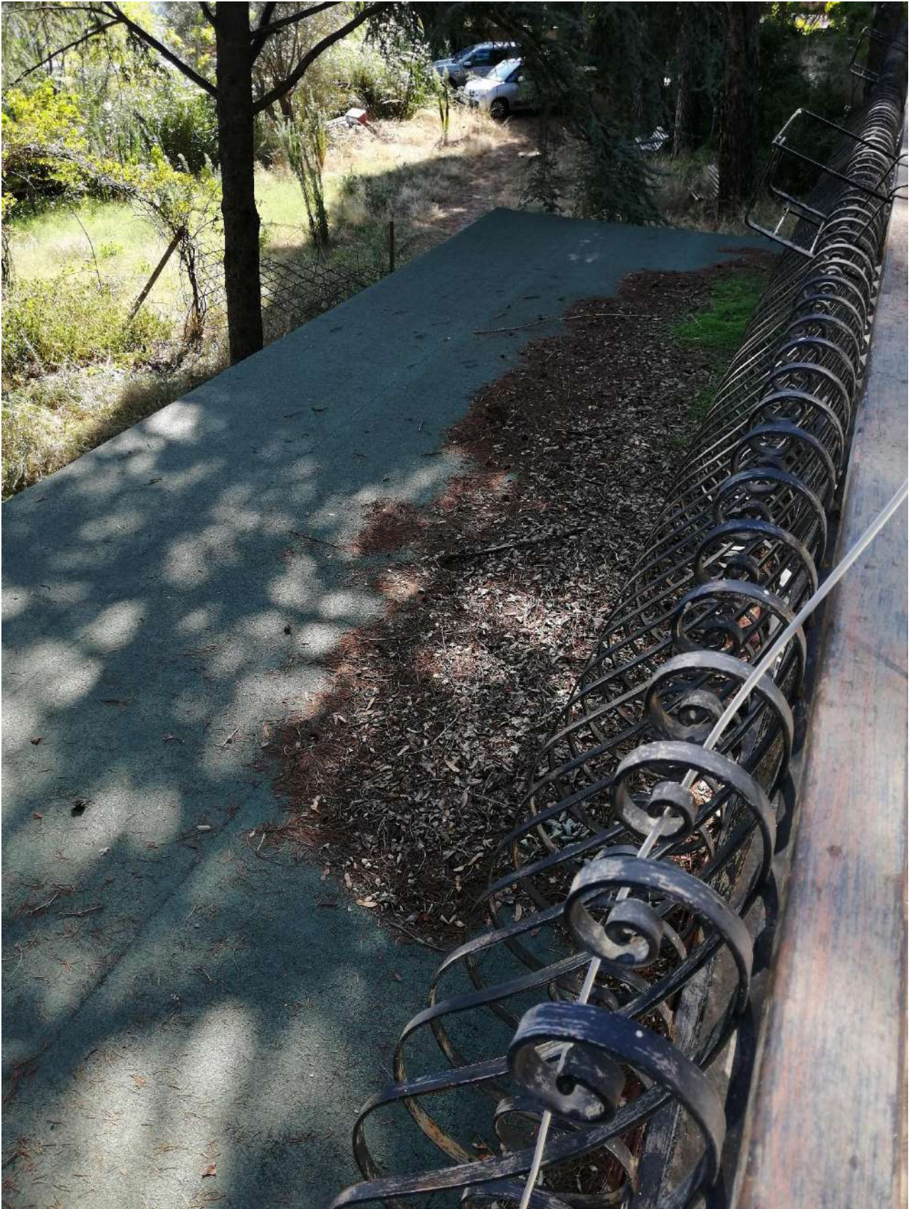
Foto n° 32 Particolare della tettoia leggera su area esterna e del balcone sul prospetto lato est
