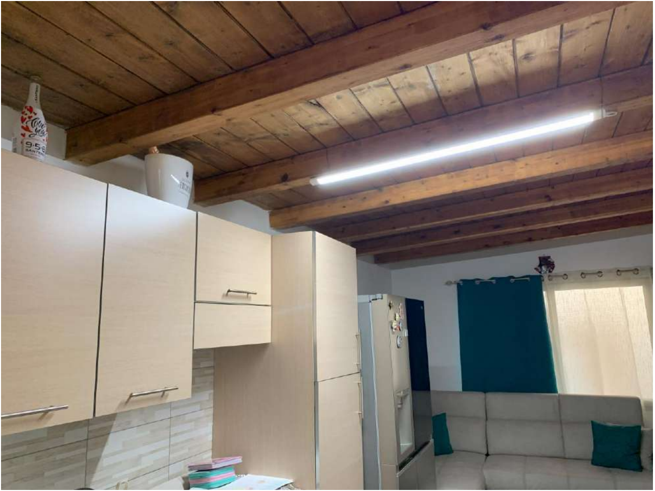
Foto n° 43 Manufatto di cui alla foto precedente veduto dall'interno
