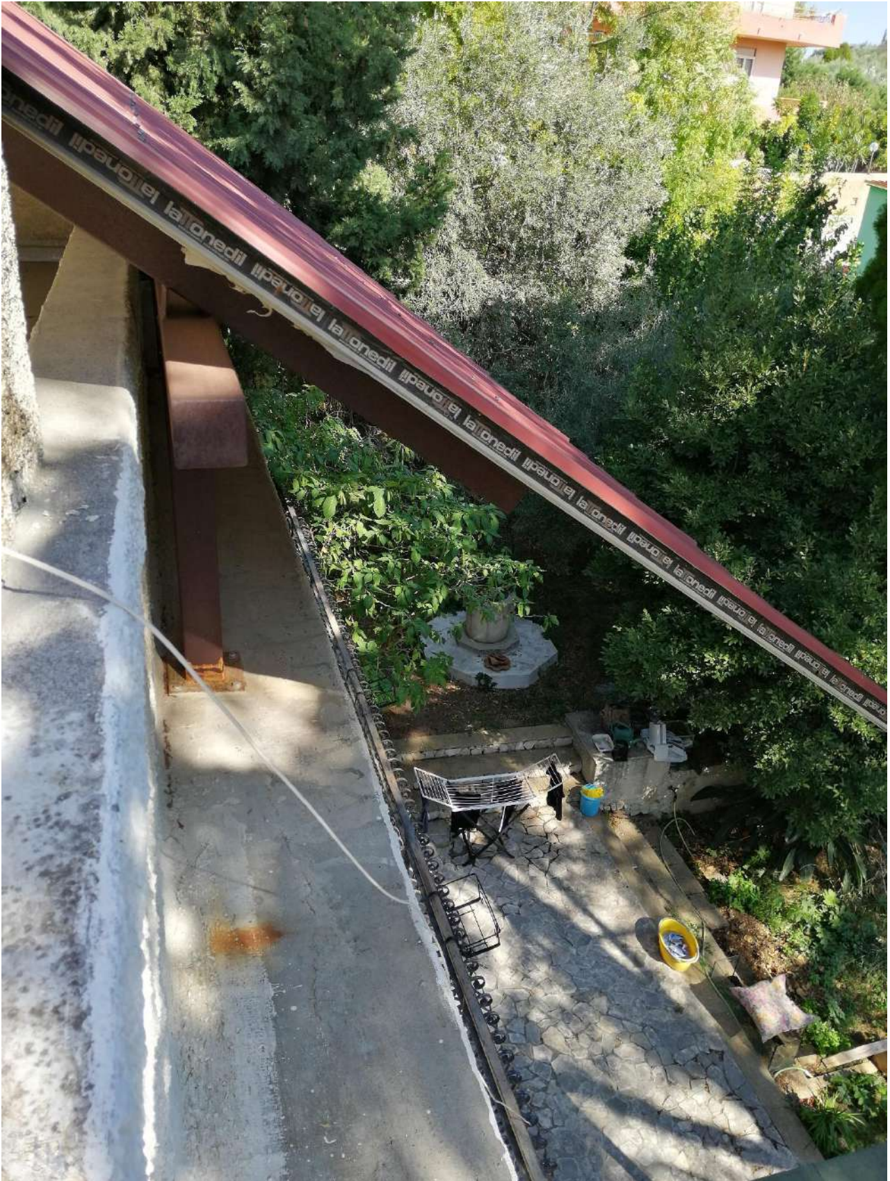
Foto n° 30 Particolare della copertura realizzata non a regola d'arte
