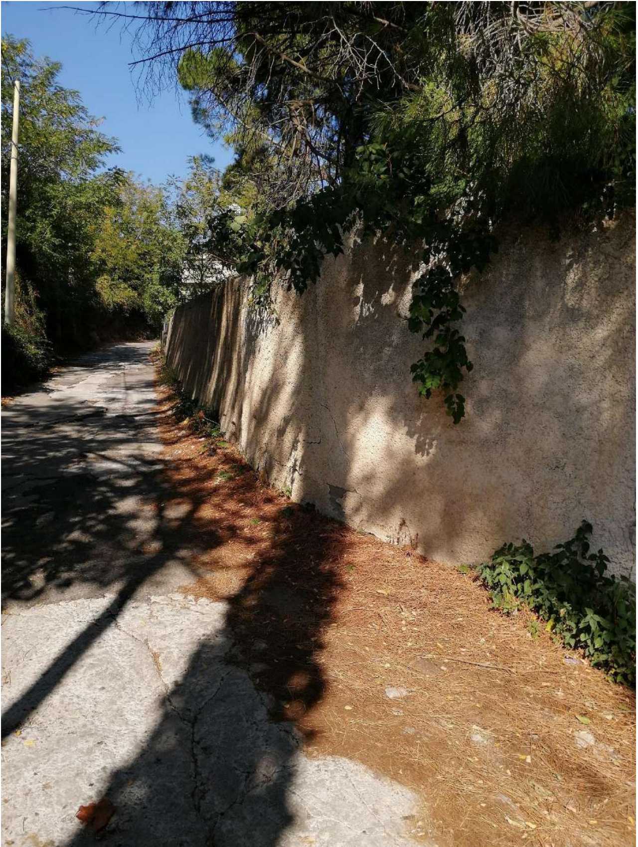
Foto n° 37 Muro di confine in evidente stato di dissesto
