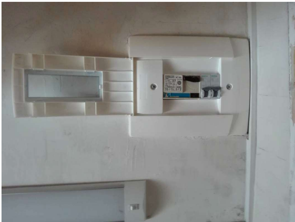
24 | Particolare quadro elettrico
