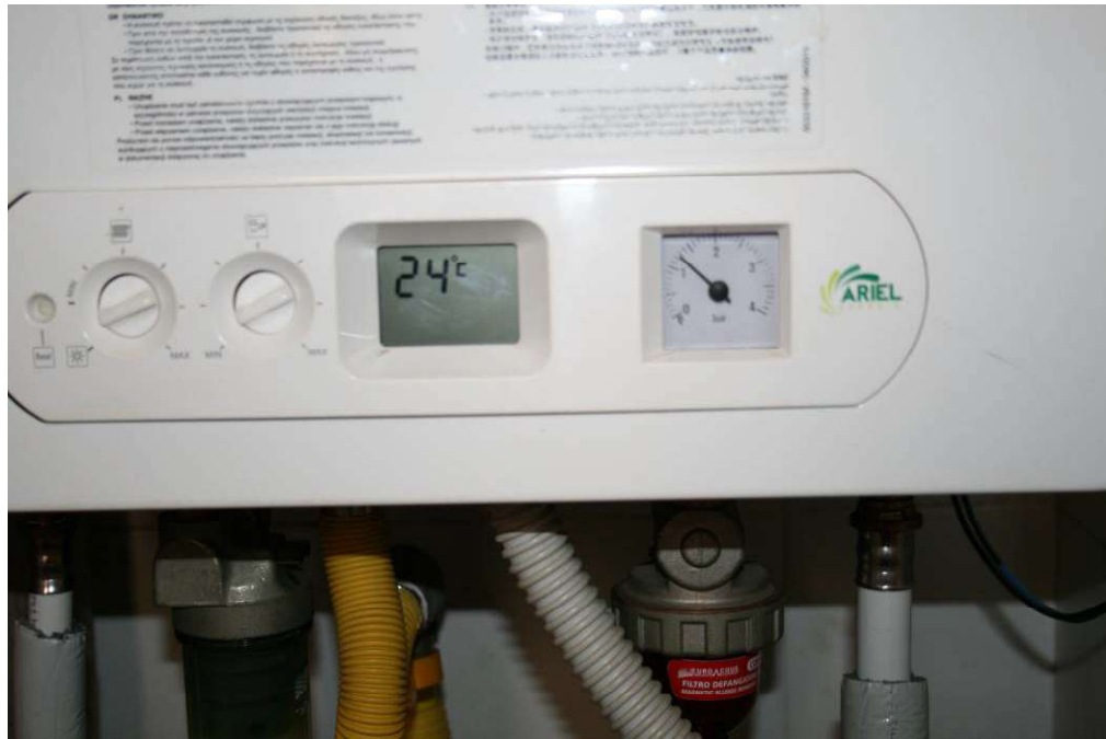
27 | Particolare generatore di calore
