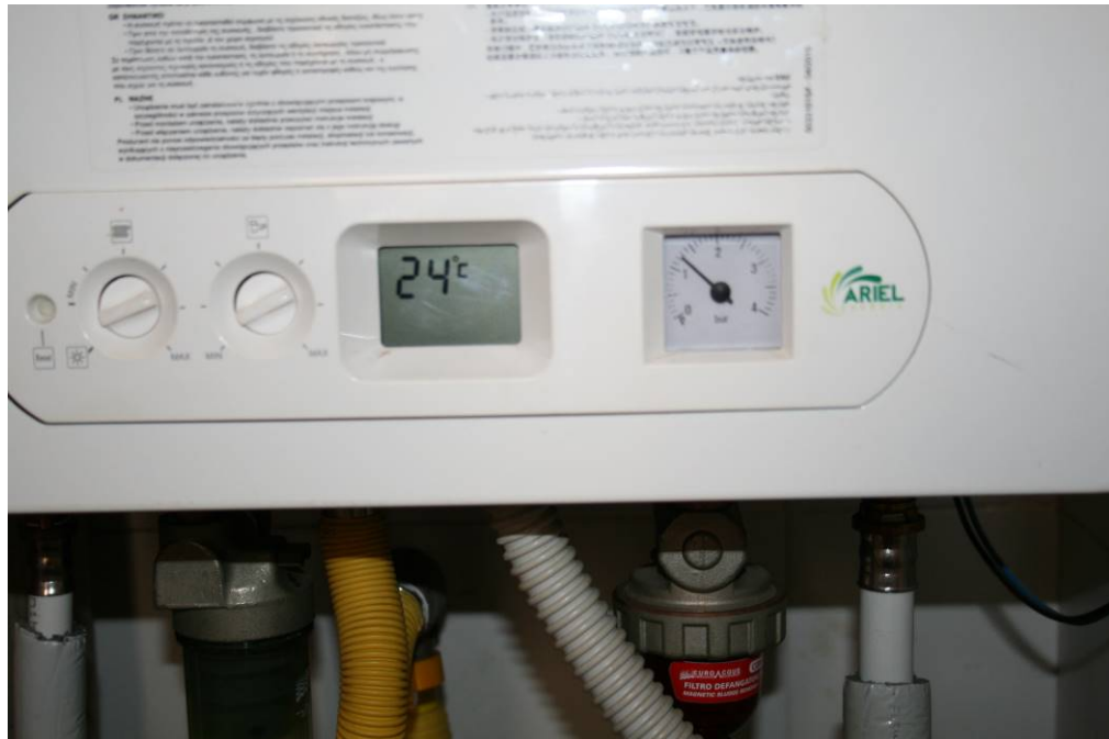
27 | Particolare generatore di calore
