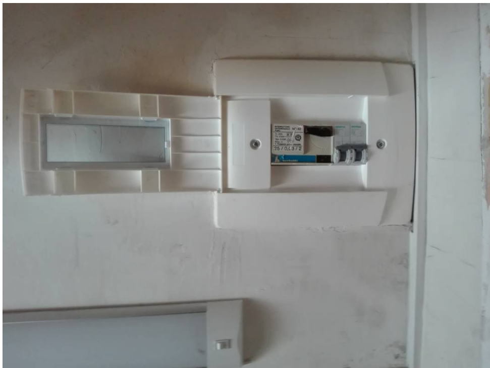
24 | Particolare quadro elettrico
