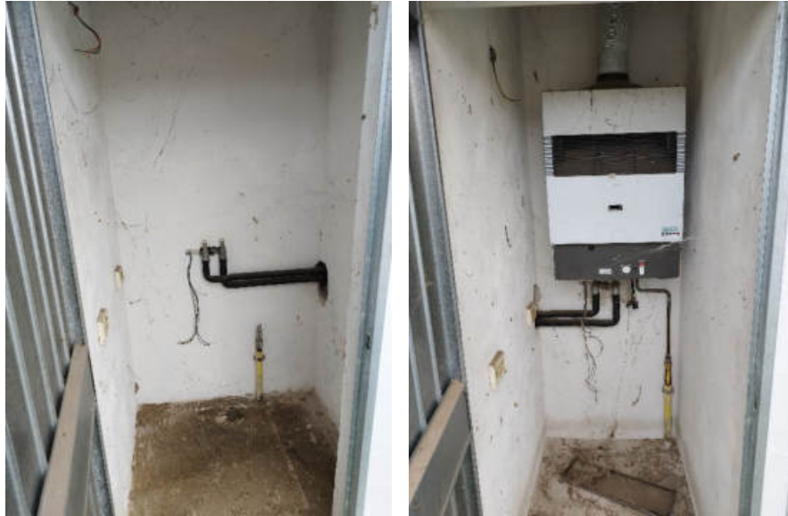
Manufatto ospitante le centrali termiche ed interni.
