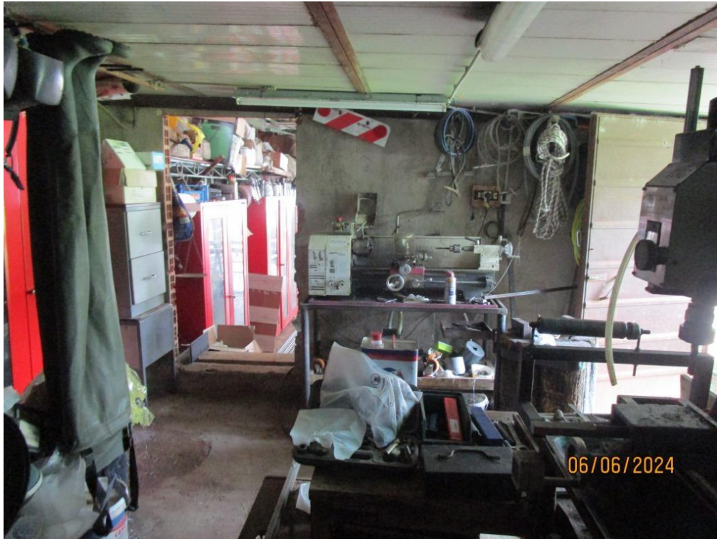
Foto 60 – Porzione di autorimessa realizzata in ampliamento senza concessioni
