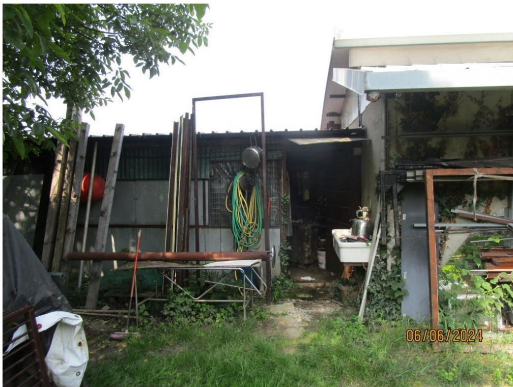
Foto 61 – Vista esterna della porzione di autorimessa realizzata in ampliamento ma in assenza di concessioni
