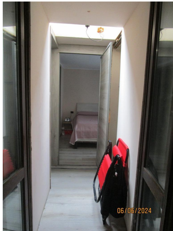
Foto 19 – Porzione di appartamento realizzata in ampliamento in assenza di titolo
