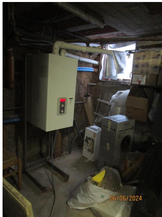
Foto 55 – Cantina con impianti tecnici a servizio di entrambe gli appartamenti
