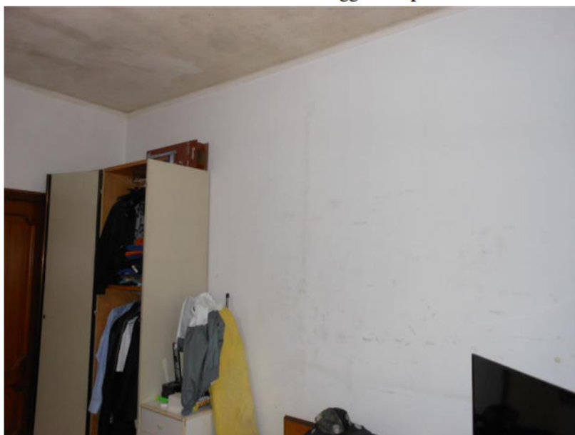
FOTO 13 – Camera immobile oggetto di procedura
