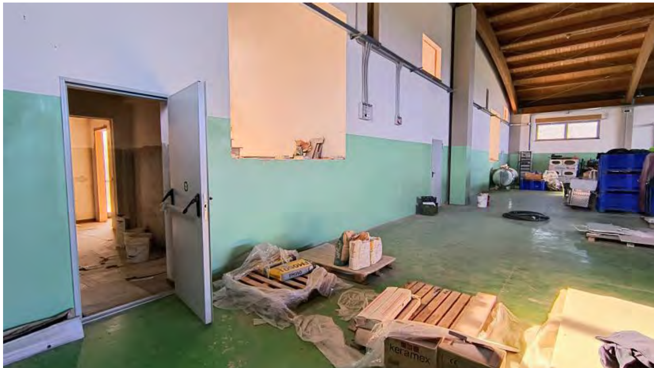
Foto 68 - Attrezzature, materiali e residui nel capannone produttivo.
