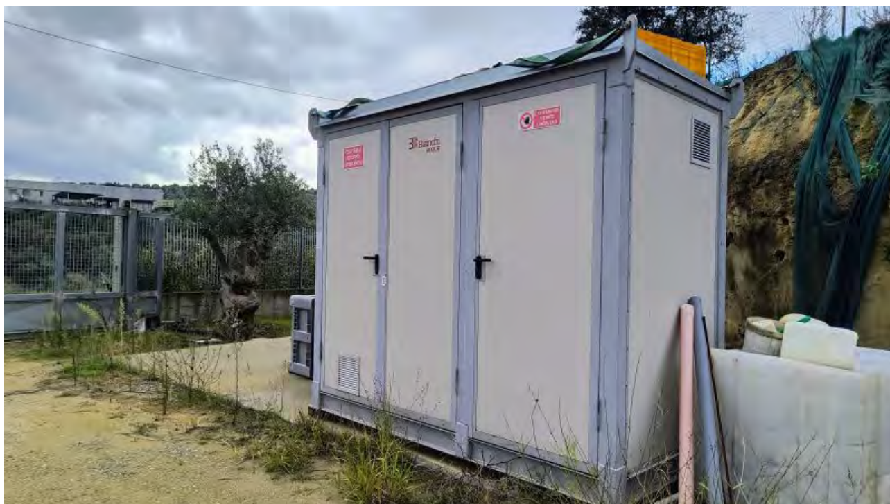
Foto 59 - Gruppo pompe impianto idrico antincendio.
