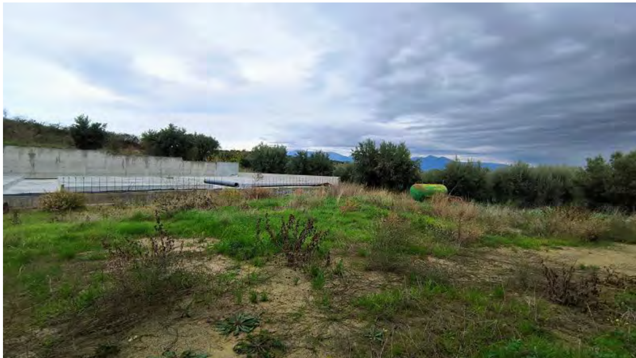
Foto 44 - Area esterna posteriore (lato Nord) con piattaforma in c.a. per basamento silos.
