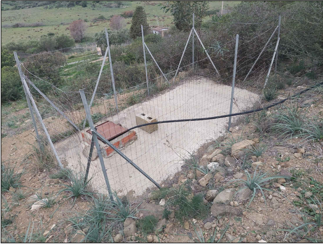
DEPOSITO IDRICO INTERRATO
