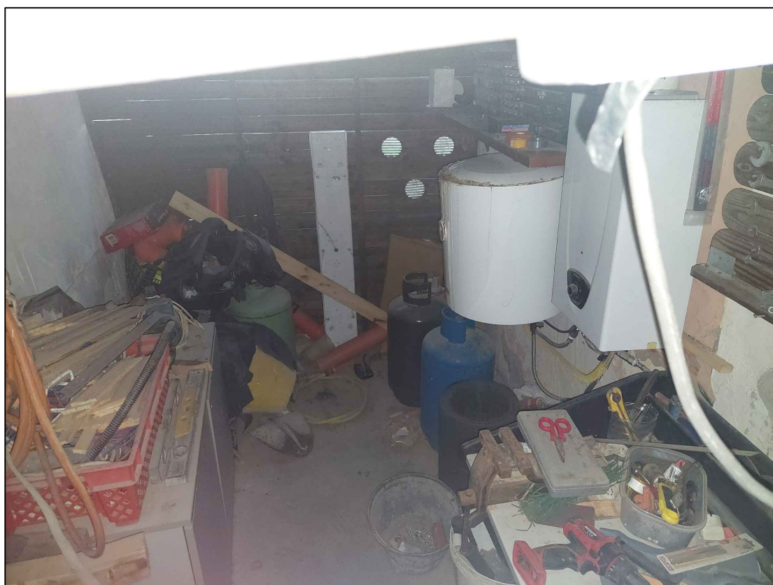
CORPO PRINCIPALE - VANO TECNICO
