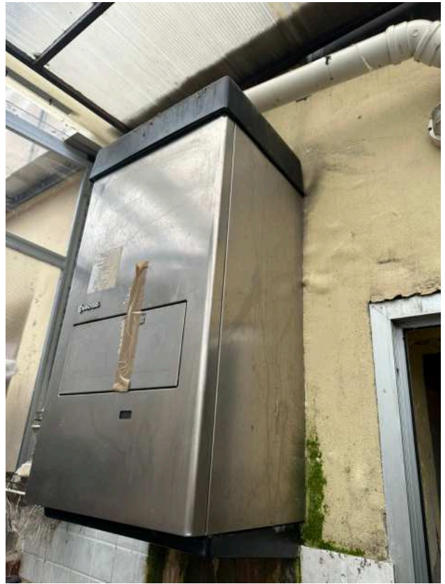
Resede tergale (caldaia)
