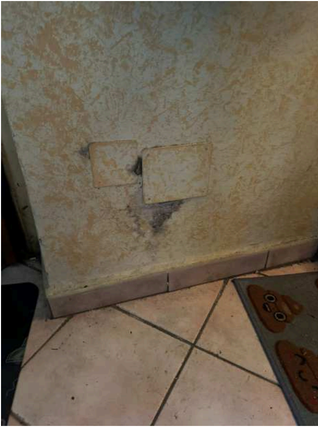
Muro soggiorno (umidità di risalita)
