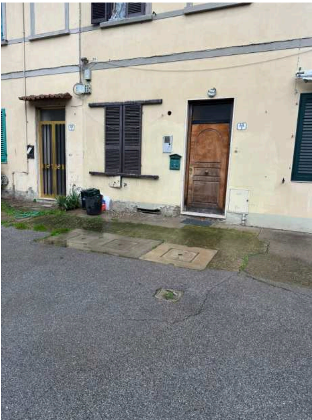
Facciata e fossa biologica
