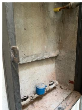
Immagine 24: Foto balconcino privato su corte interna, vano contatore acqua
