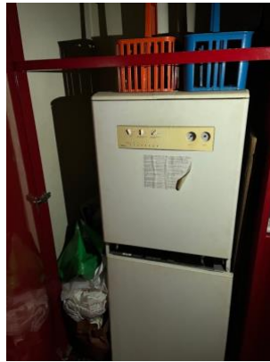
Immagine 17: particolari impiantistici.
