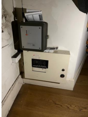
Immagine 34: Foto apparecchiature allarme nel sottoscala della scala privata che porta al piano superiore dell'alloggio.
