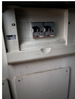
Immagine 15: particolari impiantistici.
