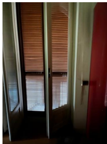
Immagine 21: Foto locale cucina, oggetto su balconcino privato.
