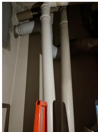
Immagine 18: particolari impiantistici.
