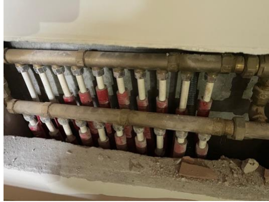
Immagine 16: particolari impiantistici.
