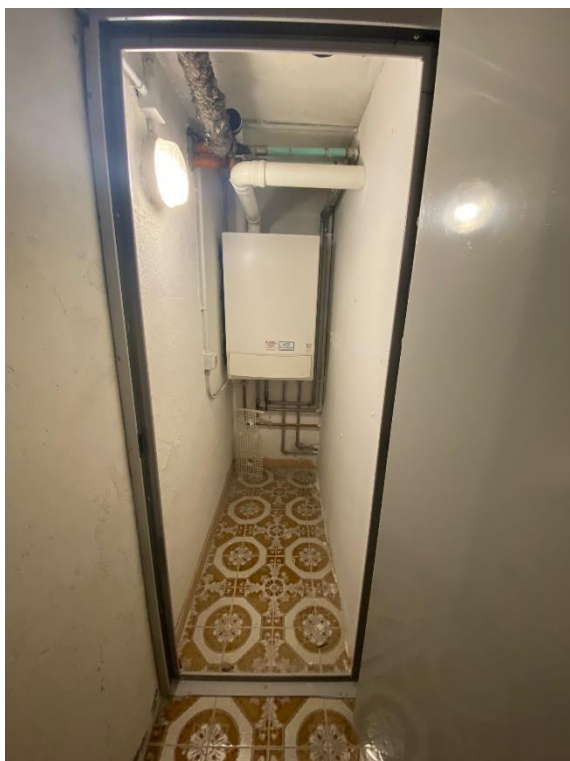
Locale Caldaia sub 2
