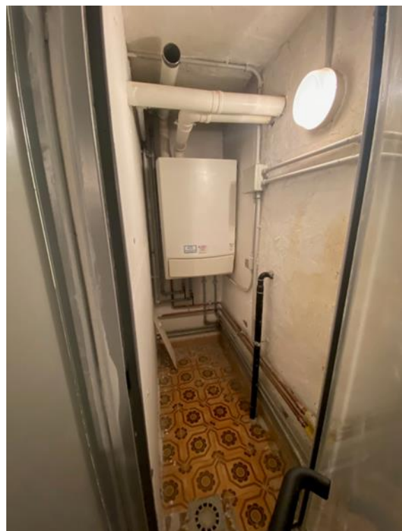
Locale Caldaia sub 1
