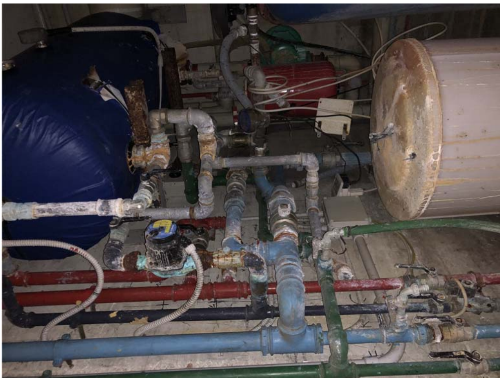
casa colonica - caldaie
