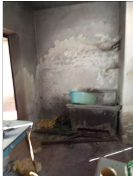
Foto 19 caldaia a comune
