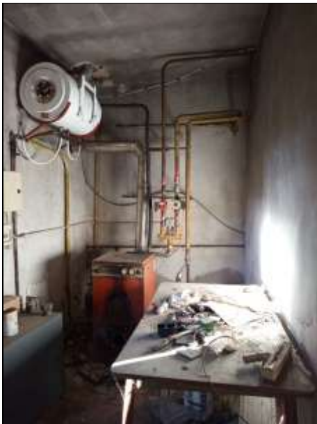
Foto 18 caldaia a comune
