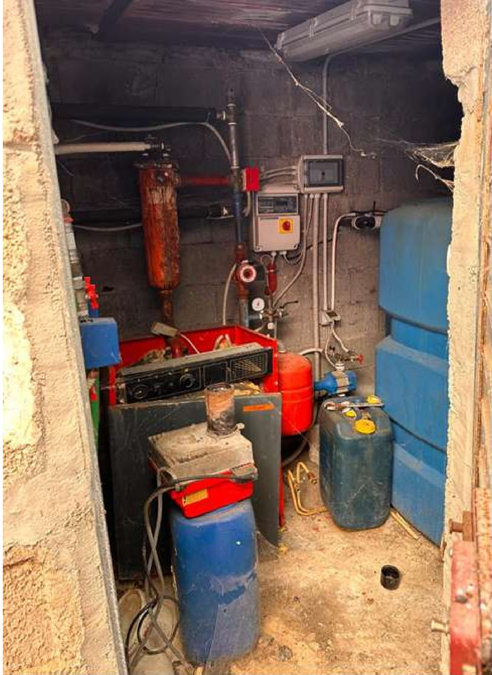
Foto 41: Locale Centrale termica per alimentazione a gasolio dei termosifoni
