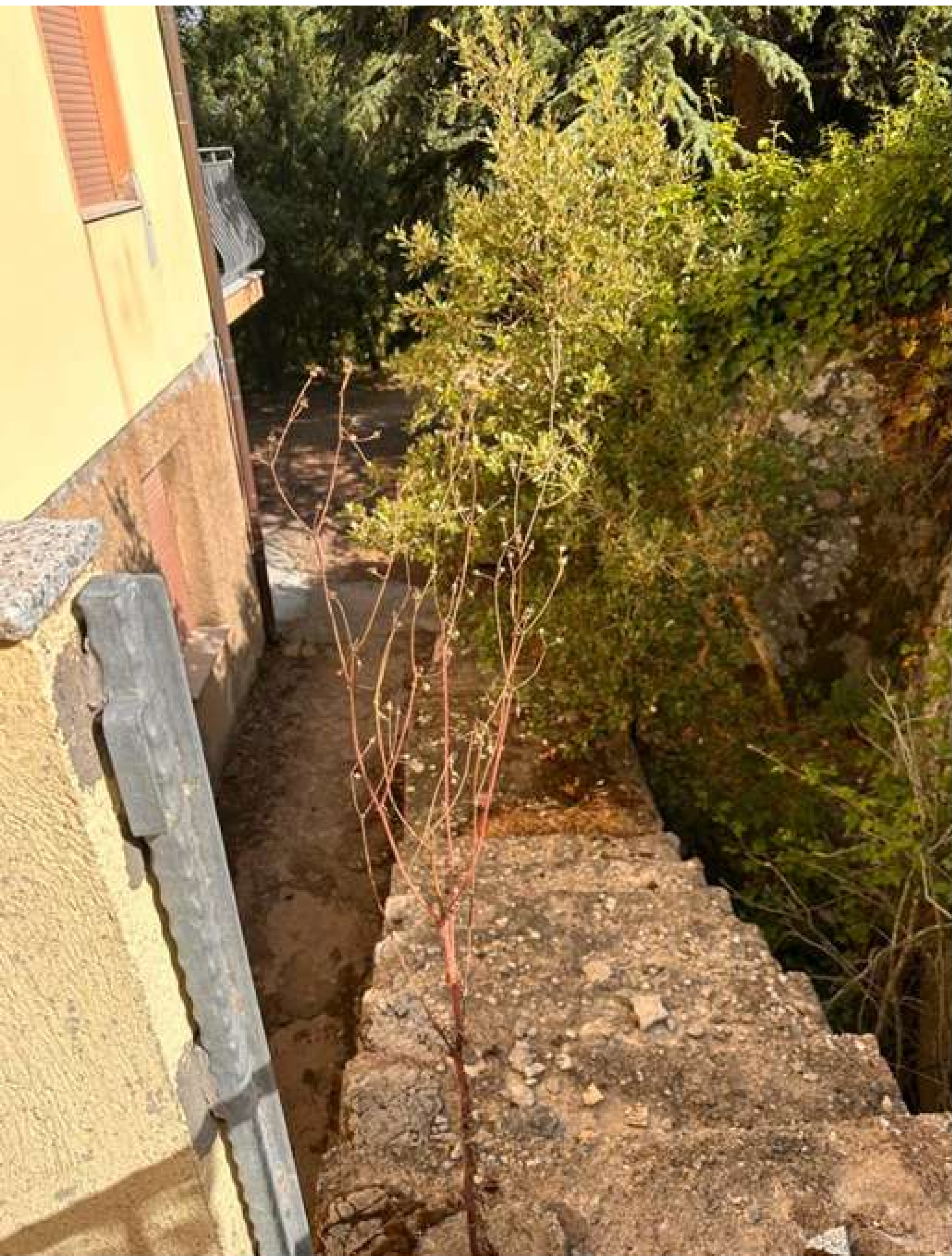
to 40: Scalinata esterna in cemento e malridotta che porta all'area esterna a Piano Terra dove c'è la centrale termica
