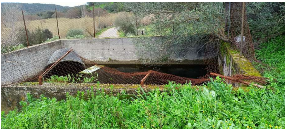
Fotografia n° 21 – vasca per riserva idrica in cemento armato
