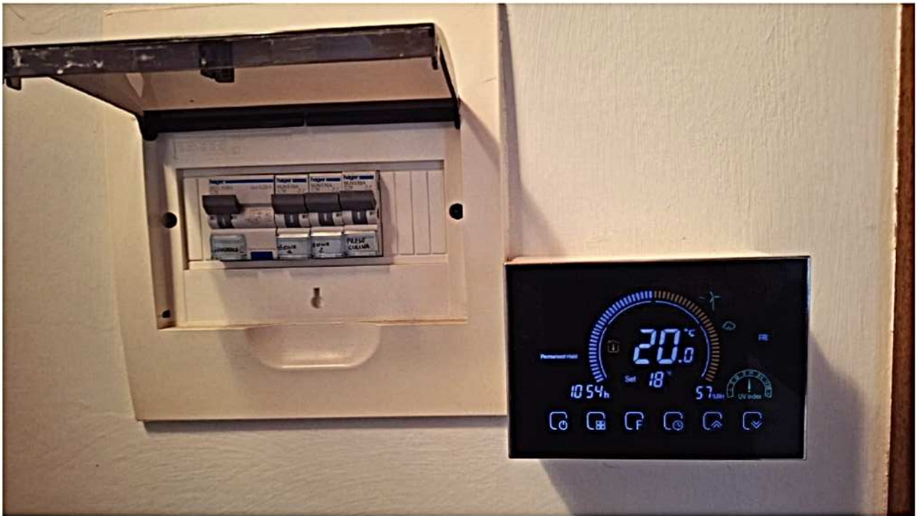
27) Quadro elettrico e termostato
