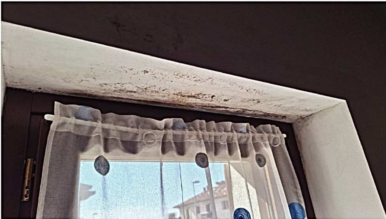
11) Umidità da infiltrazioni di acqua nella camera matrimoniale
