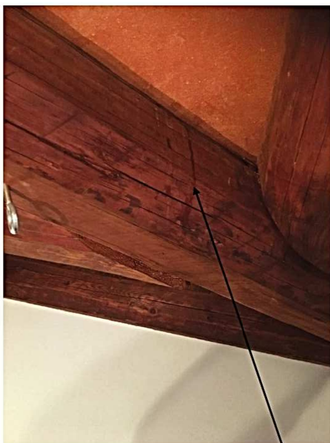
22) Perdite dalla copertura
