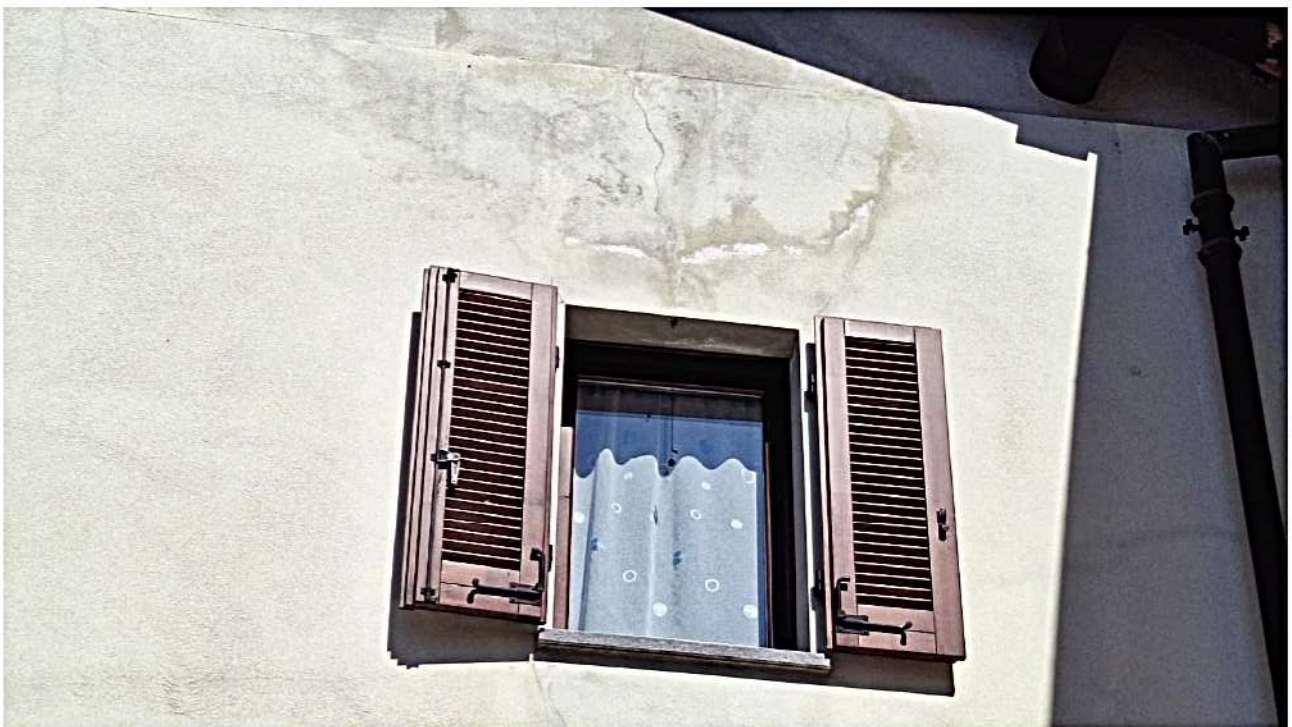
28) Facciata sud finestra camera matrimoniale infiltrazioni
