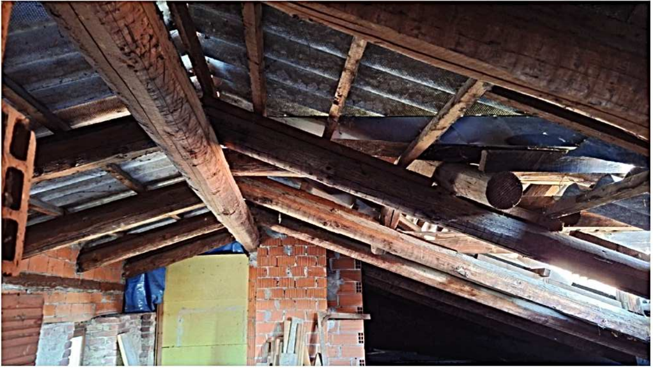
25) Sottotetto con evidenti aree di infiltrazione d'acqua
