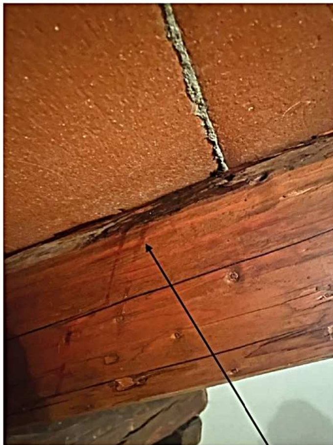
21) Perdite dalla copertura
