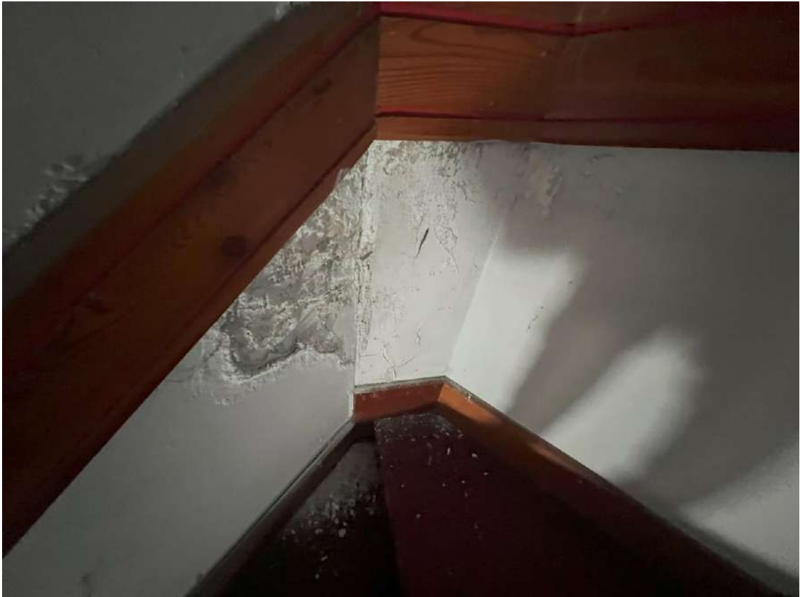
Foto 12. - Particolare pareti con esfoliazioni
