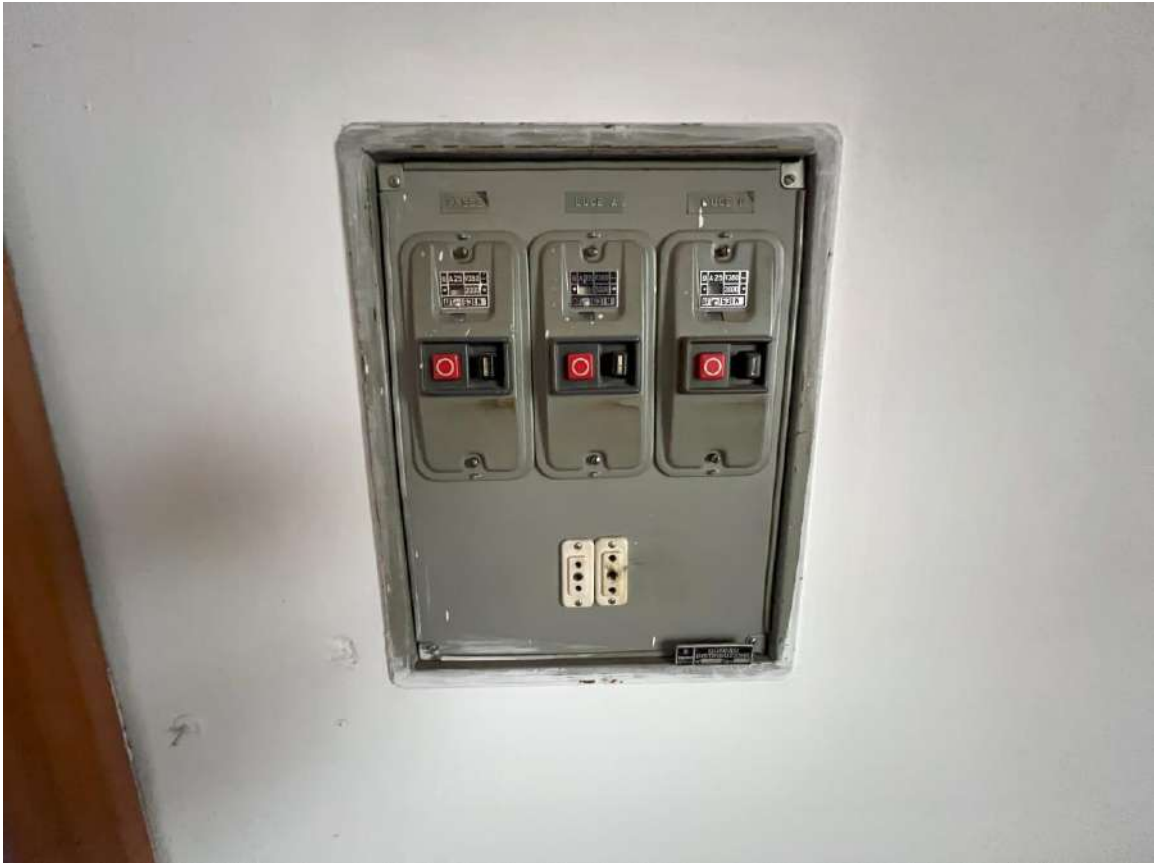
Foto 10. - Quadro elettrico vetusto e non a norma
