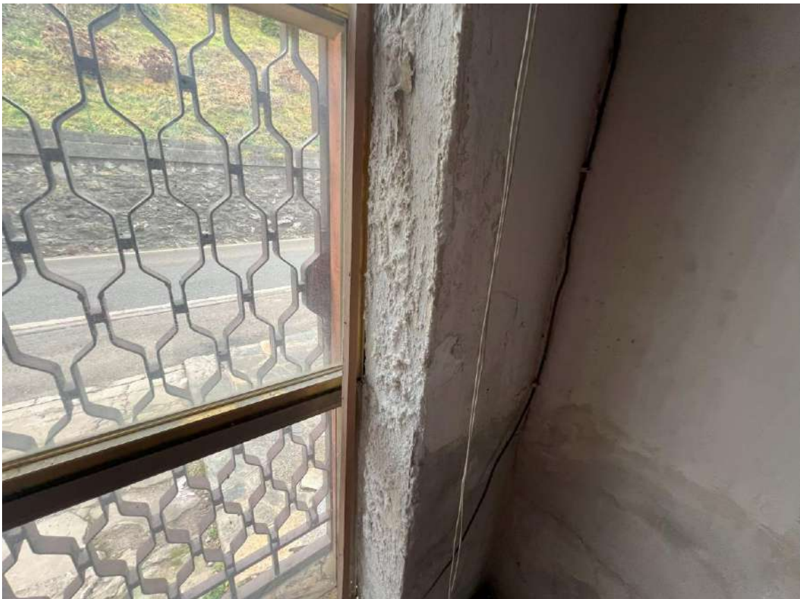
Foto 9. - Particolare pareti con esfoliazioni
