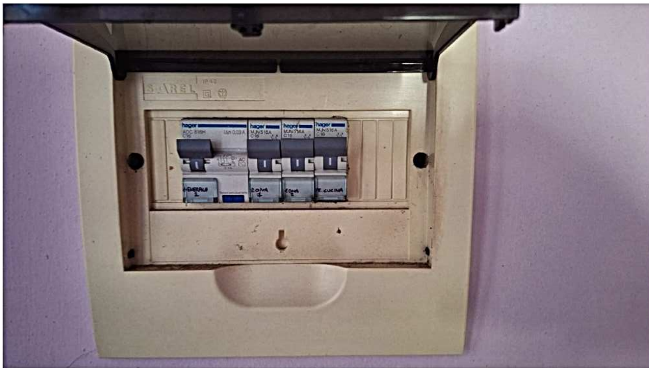
14) Quadro elettrico alloggio
