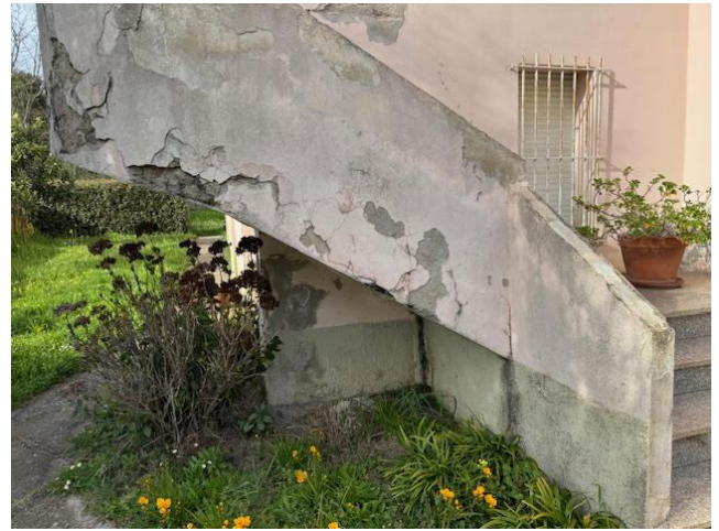
Foto 12 – particolare degrado intonaco scala Accesso al P. Terra
