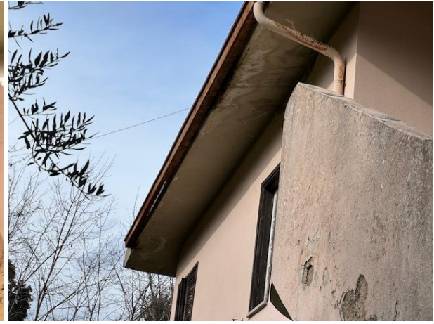
Foto 16 – particolare degrado intonaci su aggetto di copertura
