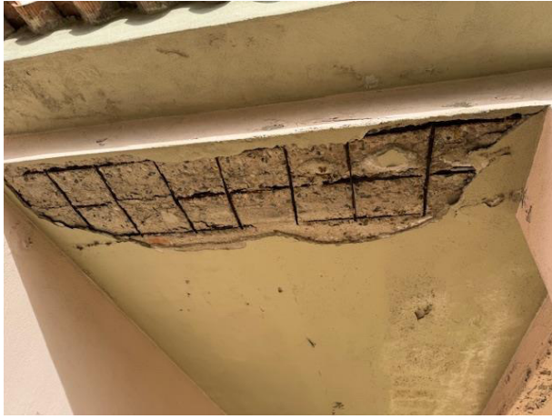
Foto 15 – particolare degrado trave esterna veranda al P. Terra
