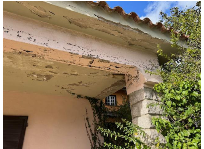
Foto 14 – particolare degrado intonaco esterno veranda al P. Terra
