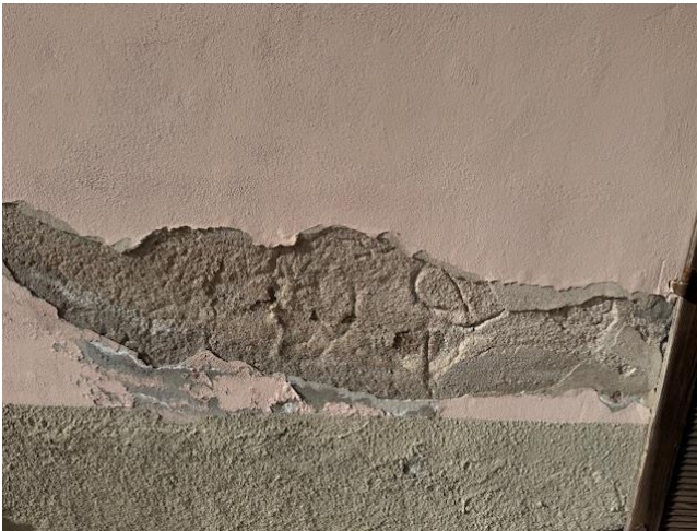
Foto 13 – particolare degrado intonaco esterno
