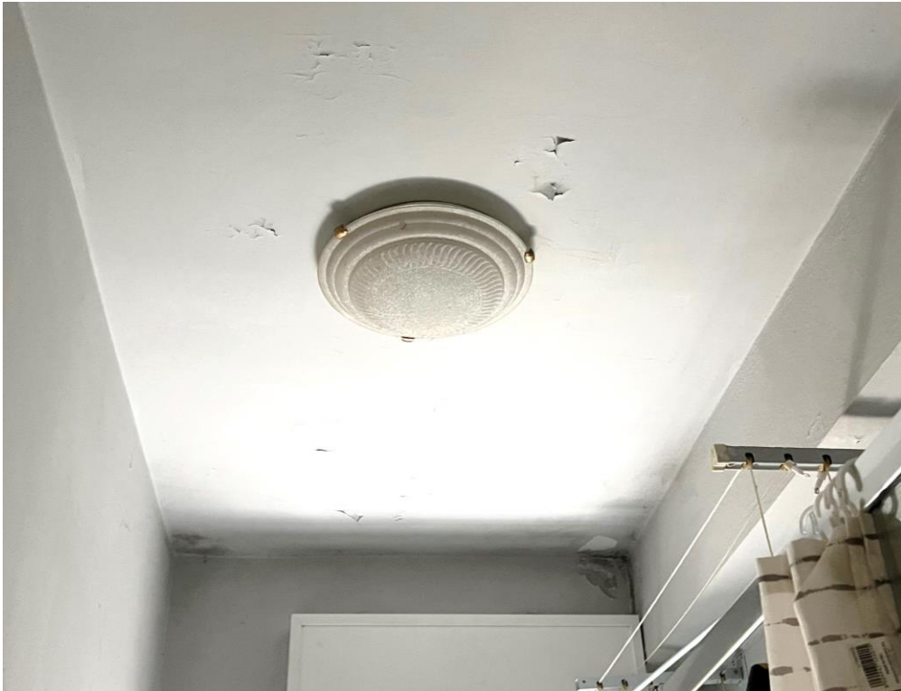
Foto 16. Particolare fenomeni di esfoliazione soffitto bagno
