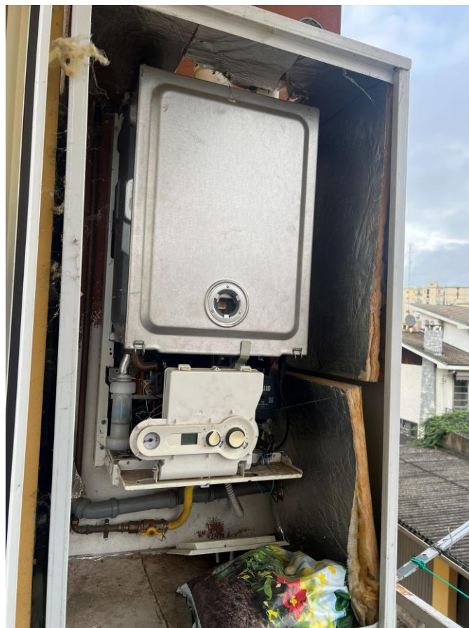
Foto 17. Stato attuale calderina
