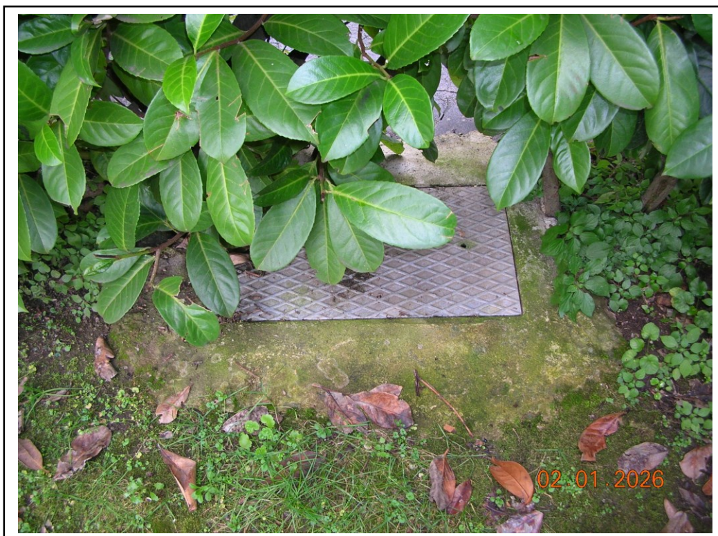
Foto 10 – Vano contatore acqua
