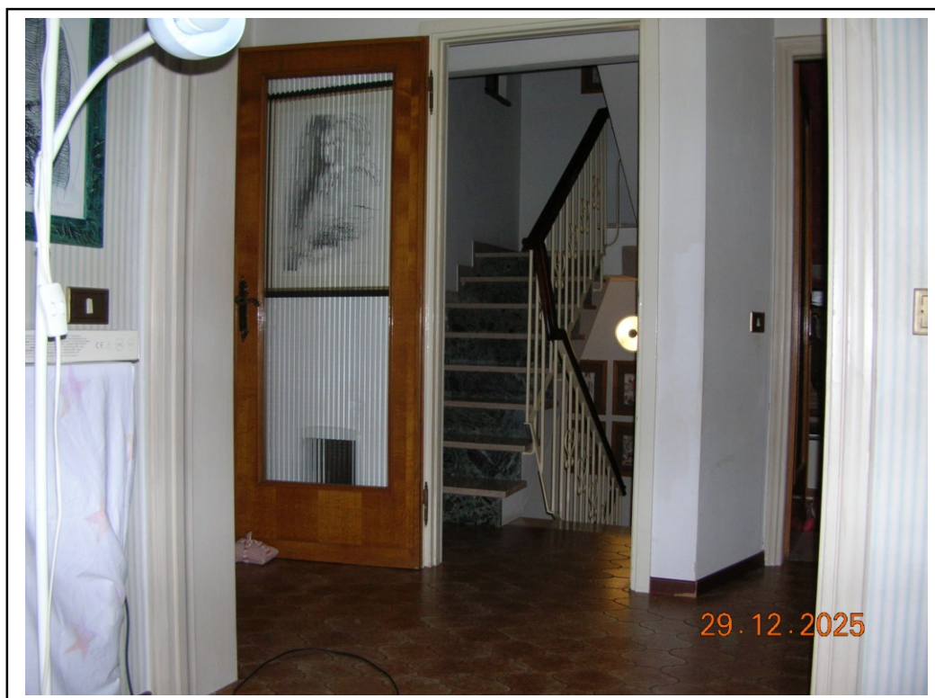
Foto 28 – Vista interna della parete a separazione del Piano Primo dal vano scala
