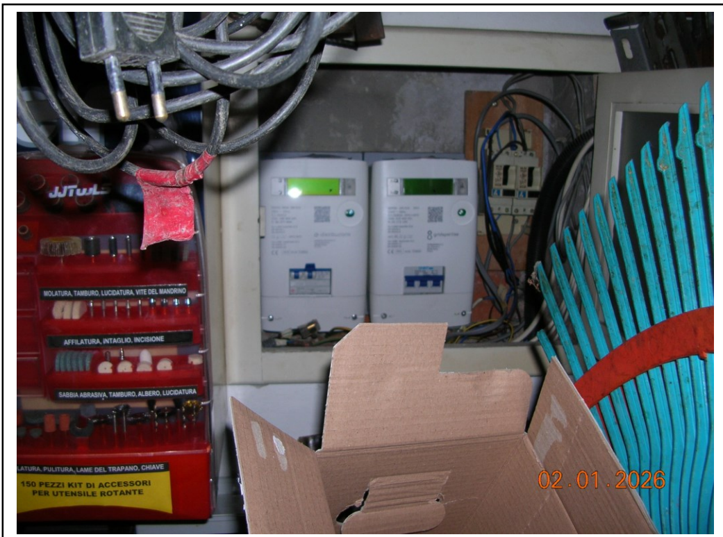
Foto 16 – Contatori Enel posti in garage
