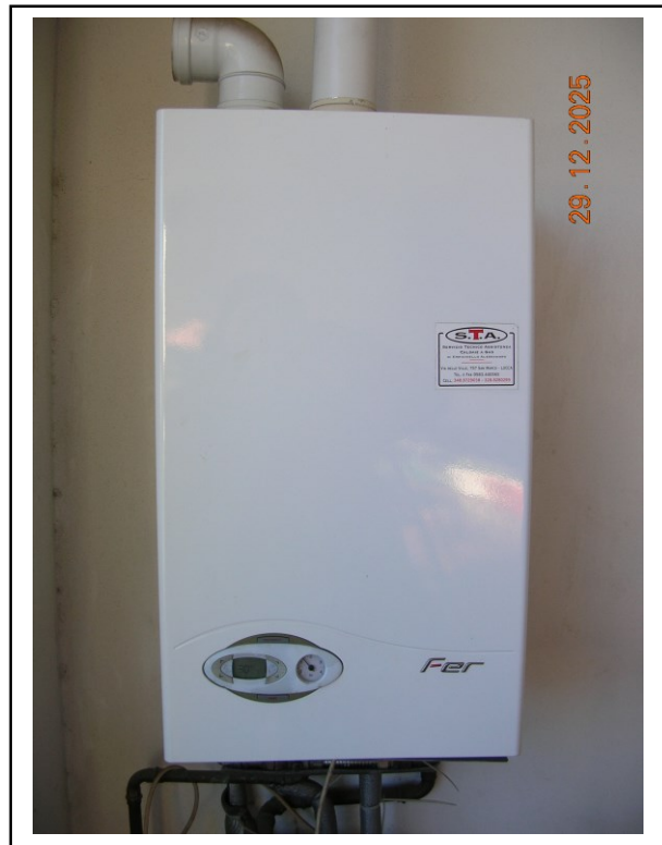
Foto 51 – Caldaia posta in terrazza
