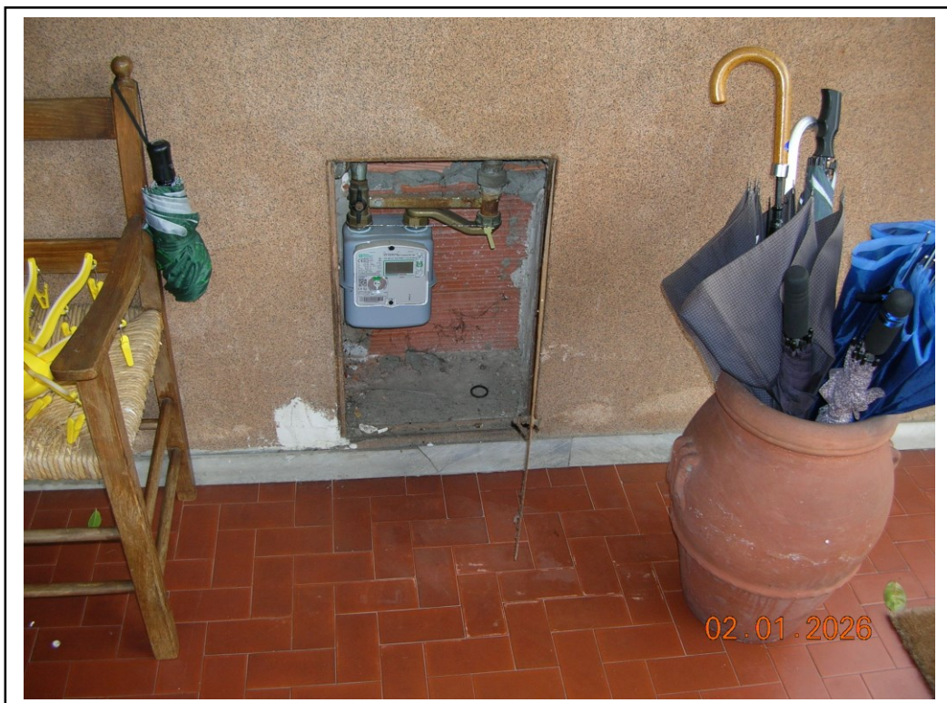
Foto 12 – Vano contatore gas metano
