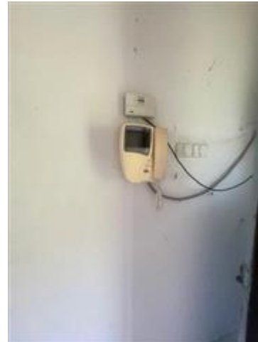
citofono al piano primo
