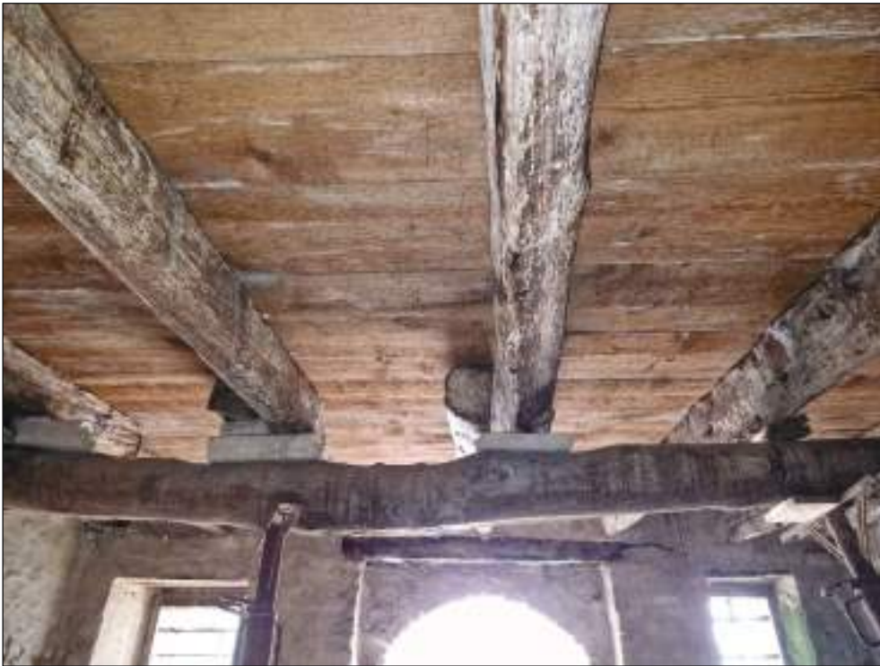
Foto 18: solaio (soffitto) cantina lato nord
