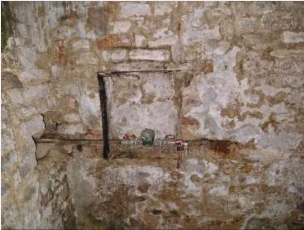
Foto 17: cantina lato nord (contatore impianto idrico)
