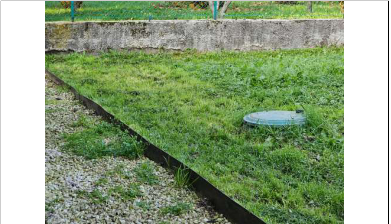
25 Particolare della copertura della bombola GPL sotterraneo;
