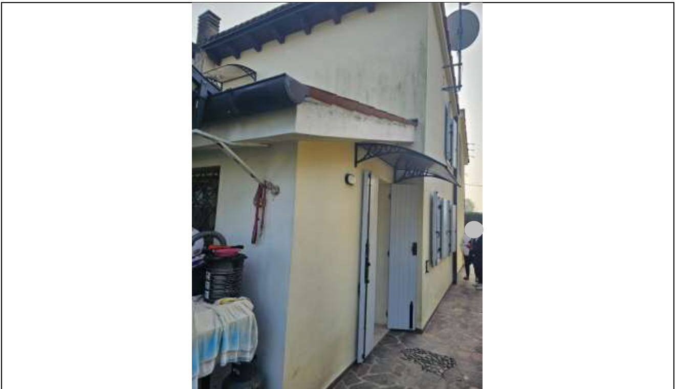
16 Vista dell'angolo Nord-Ovest dell'abitazione, con particolare della pensilina in abuso;
