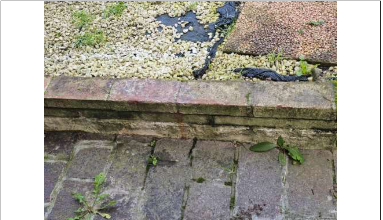
19 Vista del particolare del dislivello tra il marciapiede e la corte esclusiva;
