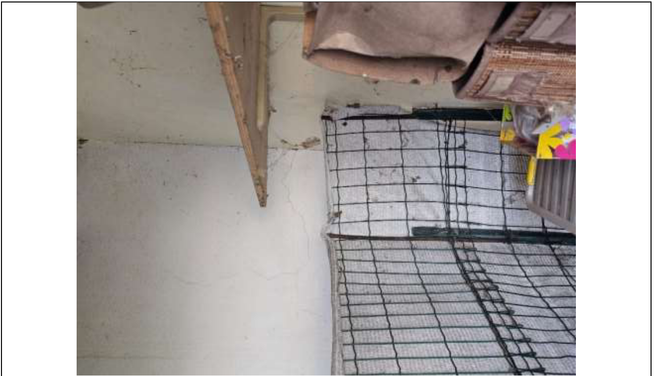
22 Vista del particolare della chiusura del confine, terminata più a ridosso dell'abitazione rispetto allo stato concessionato;
