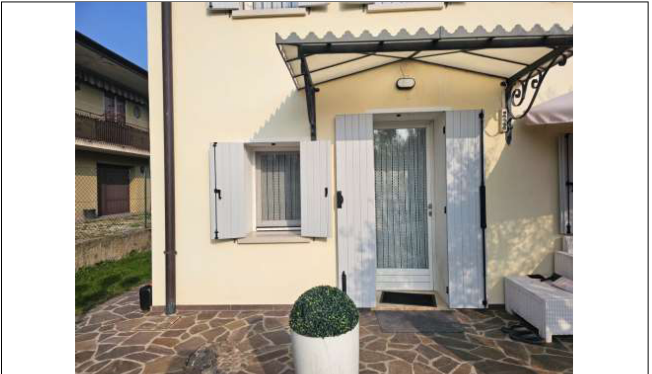
30 Vista del portoncino d'ingresso all'abitazione, con particolare della pensilina in abuso;
