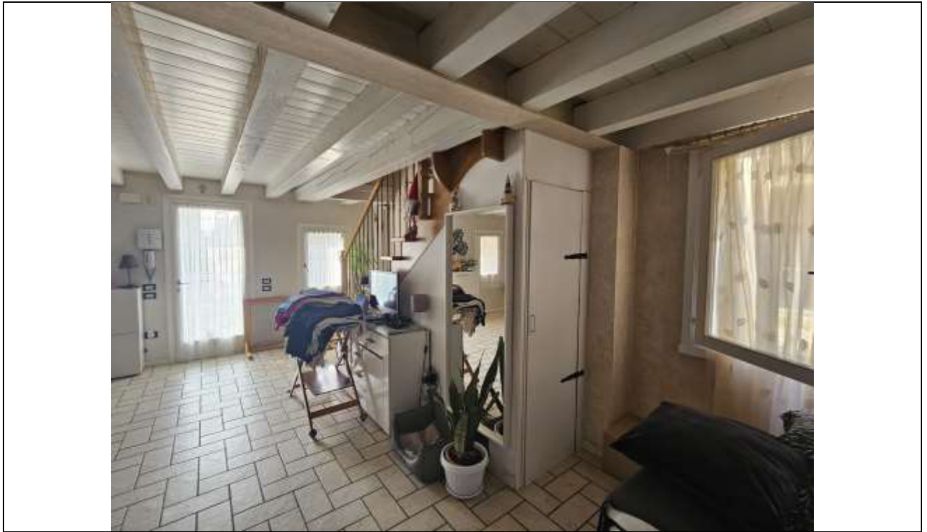
33 Vista dal soggiorno verso la scala, si nota il sottoscala ricavato abusivamente;
