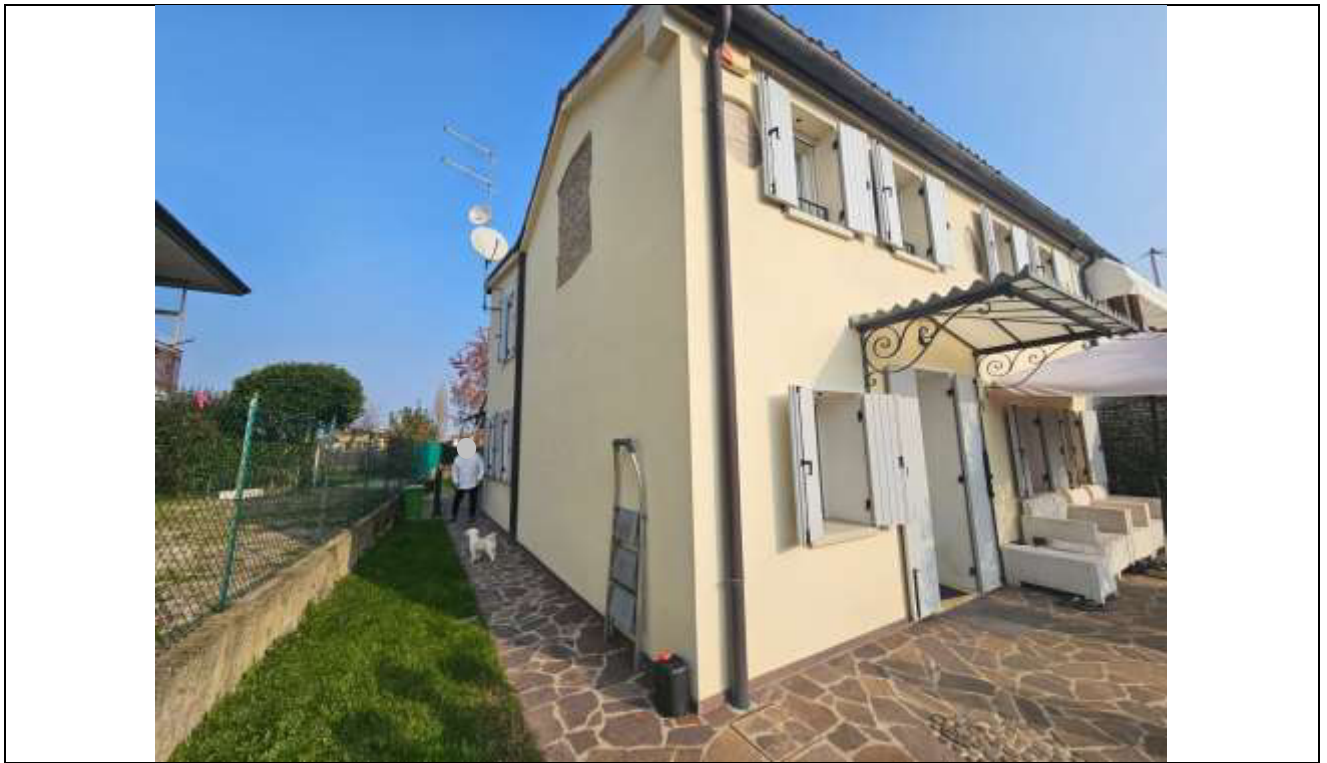
13 Vista dell'angolo Sud-Ovest dell'abitazione, con particolare della pensilina e delle tende in abuso, oggetto di rimozione;
