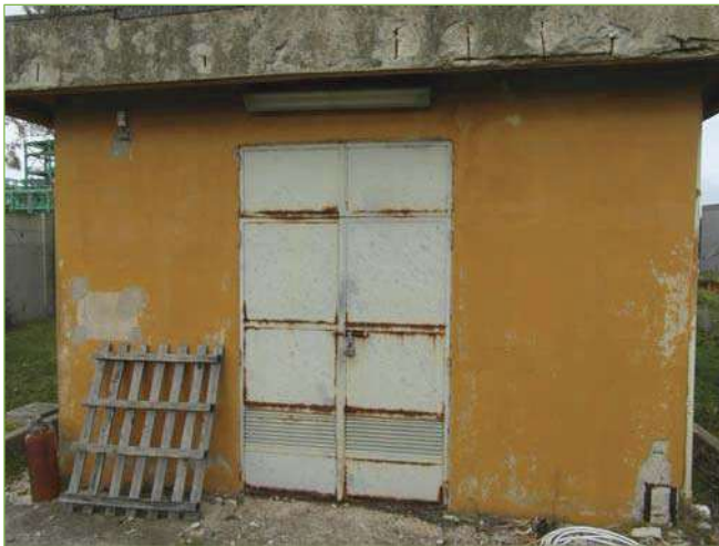
Foto n° 98: Cabina di trasformazione dell'Enel (Sub.1)
