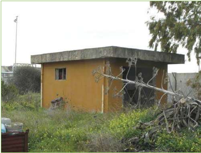
Foto n° 97: Cabina di trasformazione dell'Enel (Sub.1)
