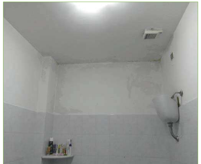
Foto n° 79: Palazzina – Piano I – Bagno unità lato Ovest (appartamento Custode) – Macchie umidità
