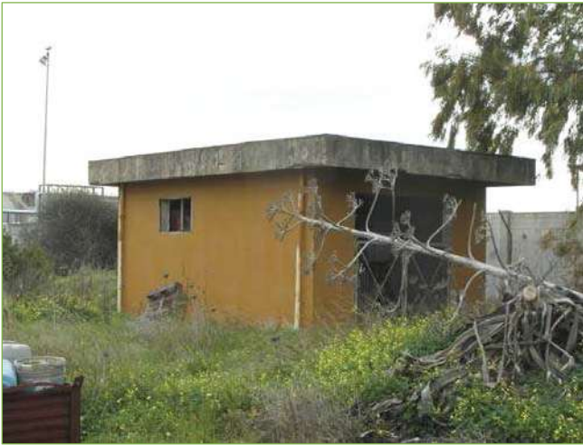
Foto n° 97: Cabina di trasformazione dell'Enel (Sub.1)
