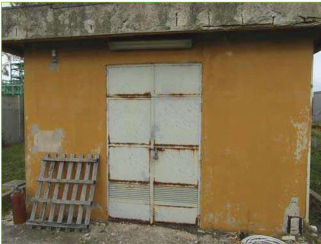
Foto n° 98: Cabina di trasformazione dell'Enel (Sub.1)
