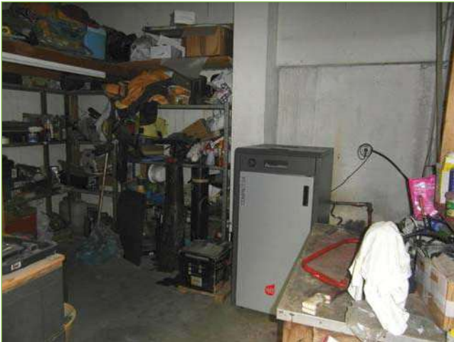
Foto n° 36: Capannone principale – Interno locale caldaia
