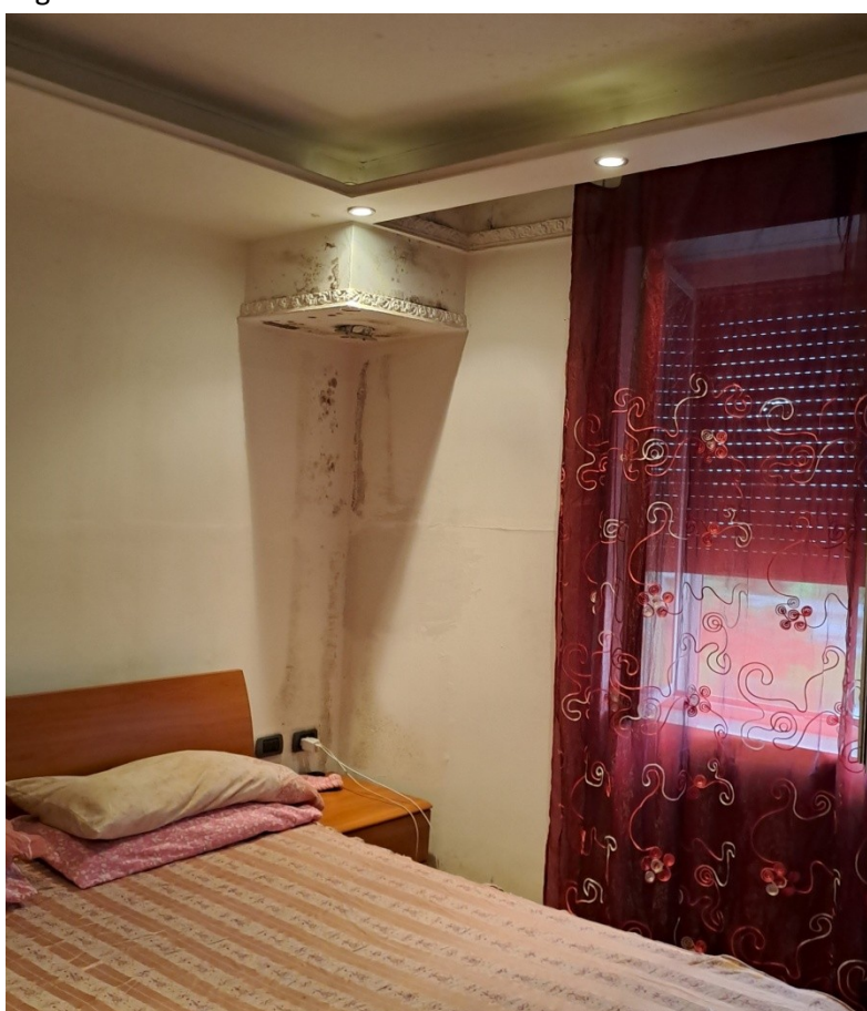
Camera 1 (si evidenzia l'ammaloramento della parete a causa dei danni provocati al manto di copertura dalla grandine, estate 2023)
