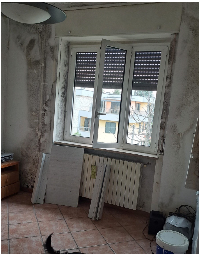
Camera 2 (si evidenzia l'ammaloramento di soffitto e parete a causa dei danni provocati al manto di copertura dalla grandine, estate 2023)
