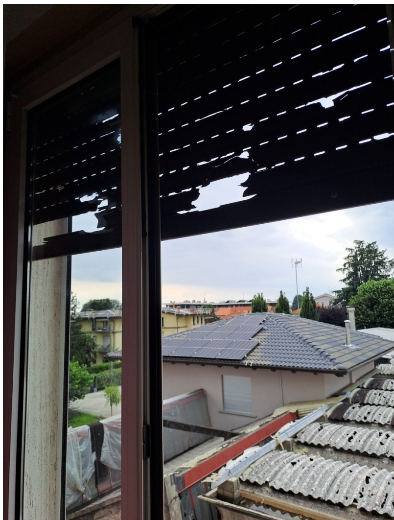
Particolare del danno ad una tapparella provocato dalla grandine (estate 2023)
