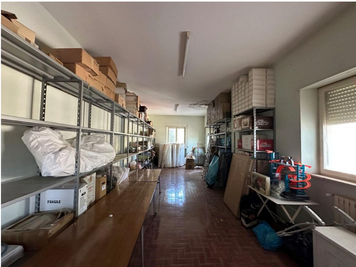
Rif. 6 con tracce infiltrazione da soffitto
