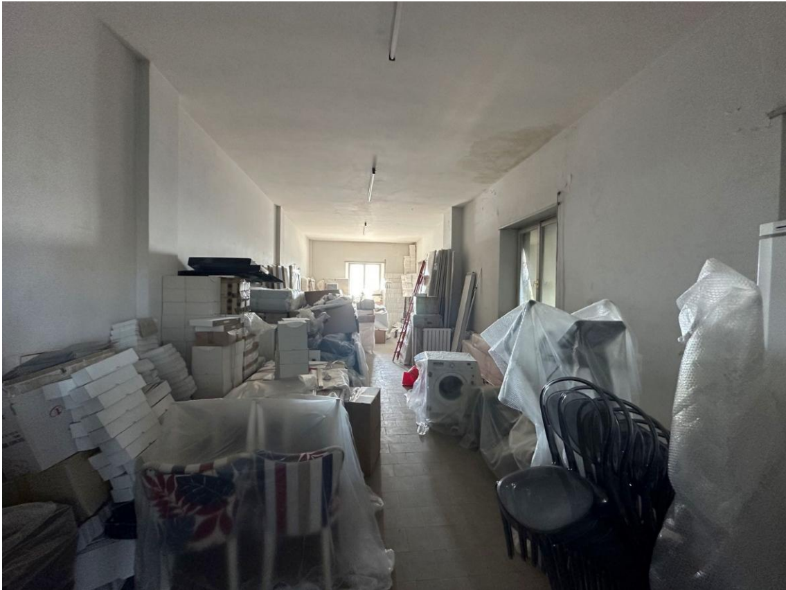
Rif. 5 con tracce infiltrazione da soffitto
