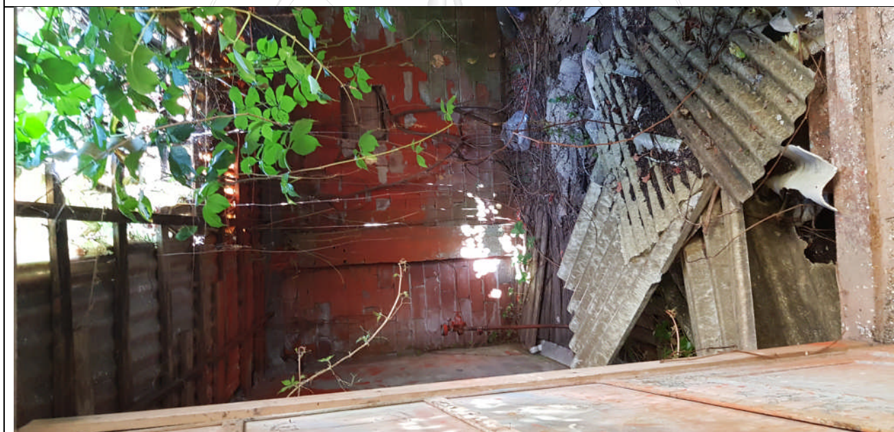
Vista interna Locale 4 – copertura crollata
