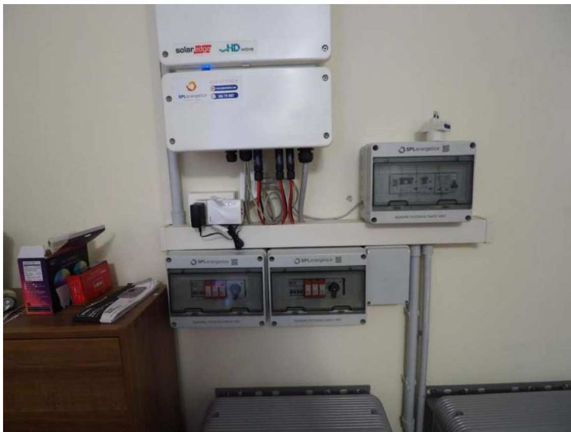
Porcia, via Romagna n. 30, P.T. – Particolare dell'impianto termico e dell'impianto fotovoltaico.
