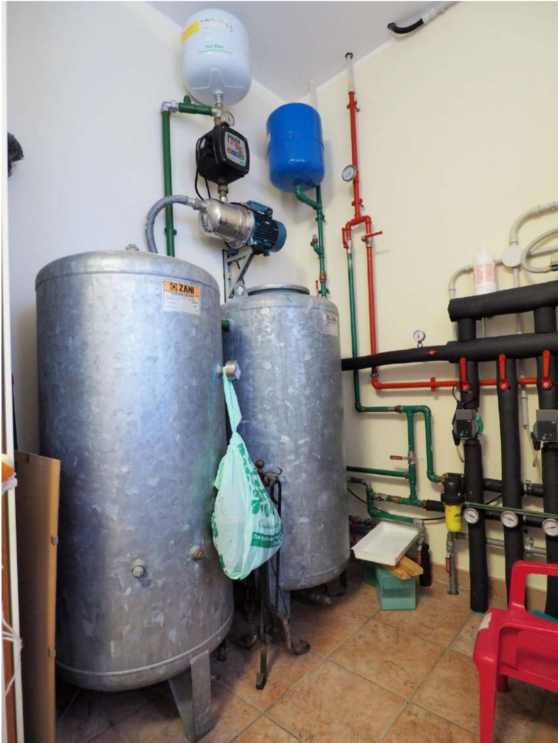
Porcia, via Romagna n. 30, P.T.ì. – Particolare del collettore, del gruppo pompe e degli accumuli .
