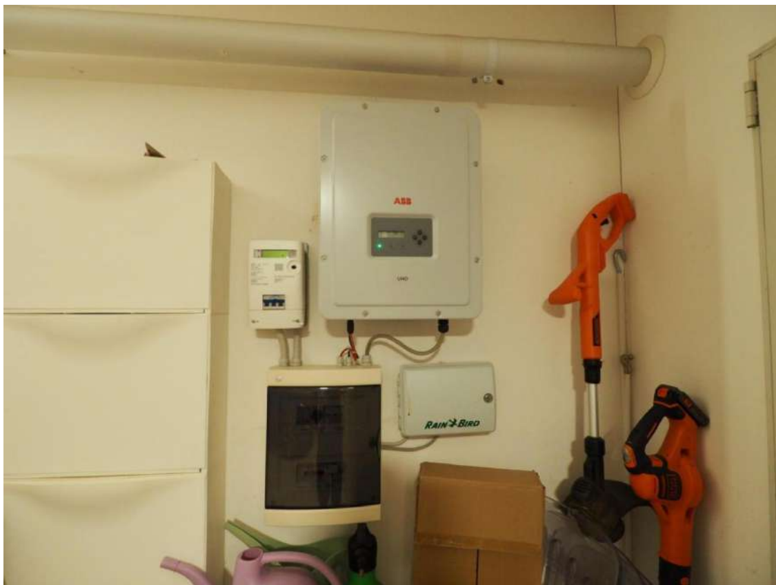
Pordenone, via Montereale n. 64 – Il condizionatore e il particolare dell'impianto fotovoltaico.
