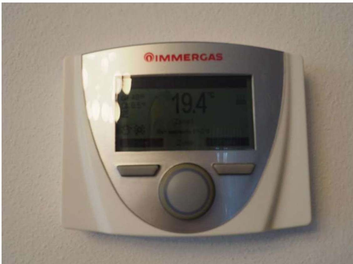
Pordenone, via Montereale n. 64 – Particolari dell'impianto termico.
