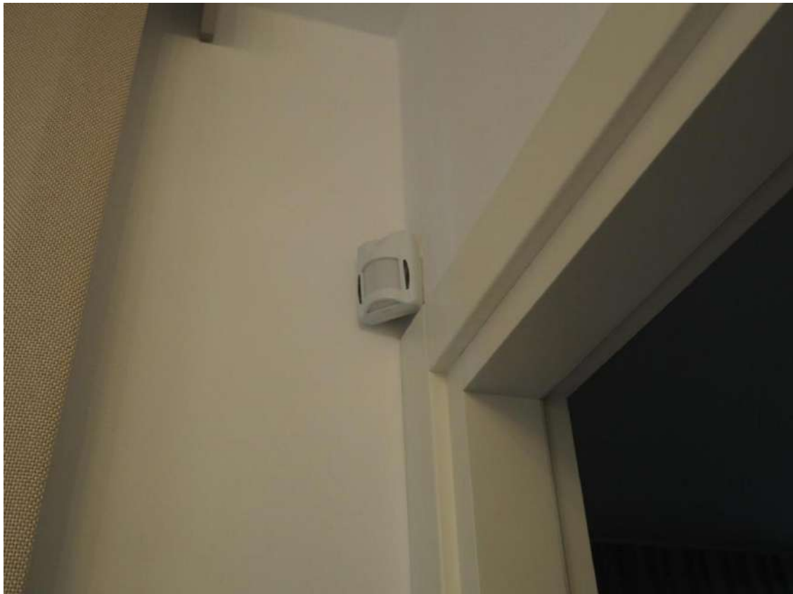
Pordenone, via Montereale n. 64 – Particolari dell'impianto d'allarme.
