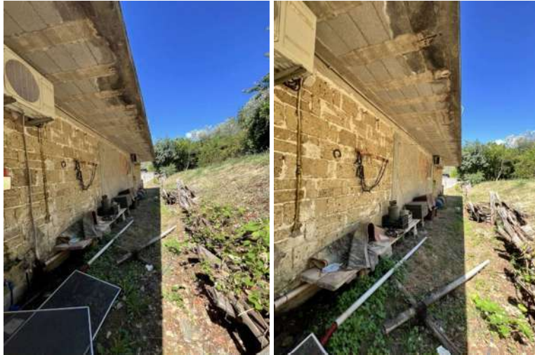
Rilievo fotografico CTU del 10.07-09.09.2025: ulteriori riprese da altre angolazioni della porzione di unità abitativa ABITAZIONE 1, ispezionata in data 1° accesso CTU.
