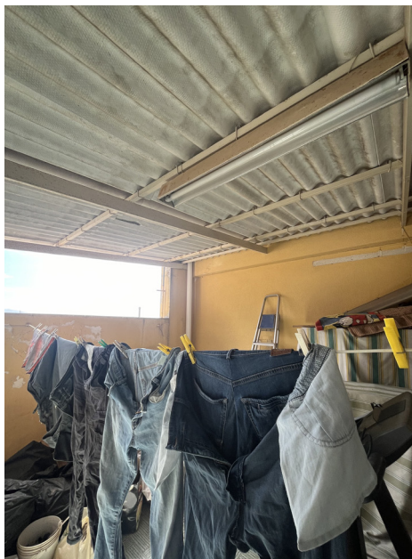
Foto 35 -Terrazza fronte Nord-Est avente copertura in ETERNIT
