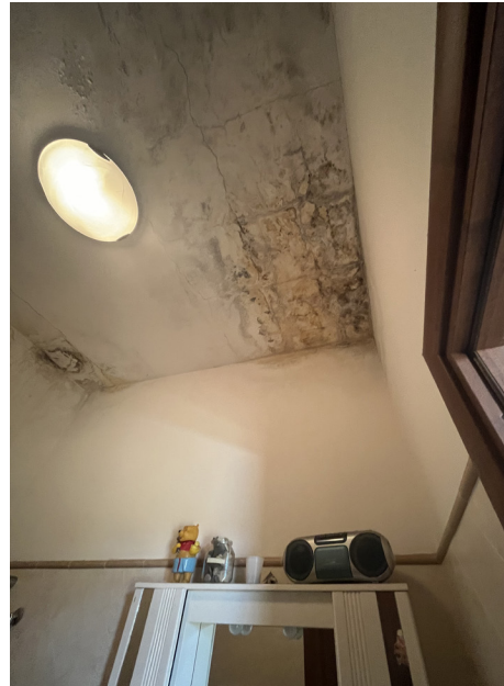
Foto 26 - Ammaloramento presente al secondo piano
