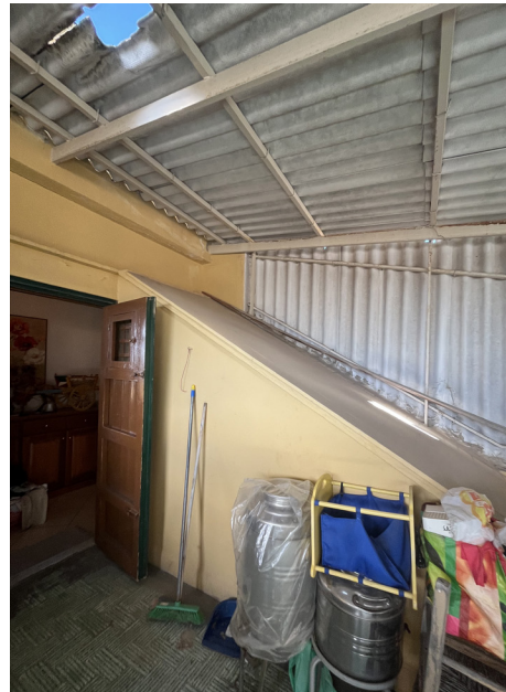
Foto 34 - Terrazza fronte Nord-Est avente copertura in ETERNIT
