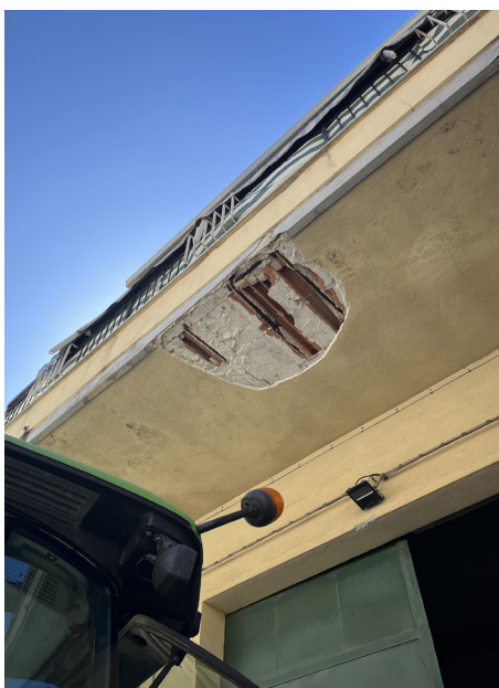
Foto 8 - Ammaloramento dell'intradosso del balcone
