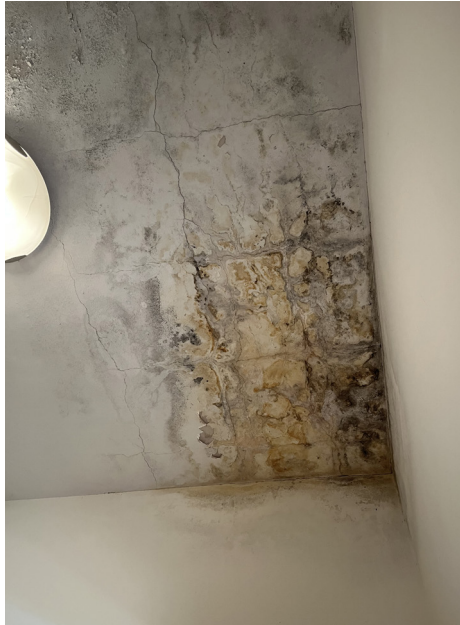
Foto 25 - Ammaloramento presente al secondo piano
