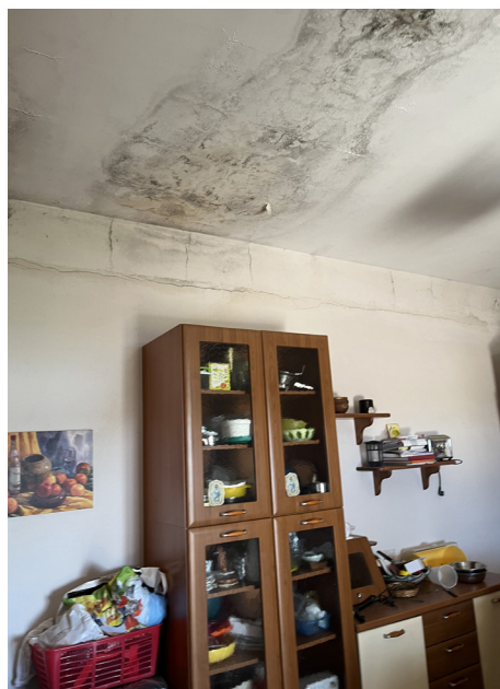
Foto 22 - Ammaloramenti presenti al secondo piano
