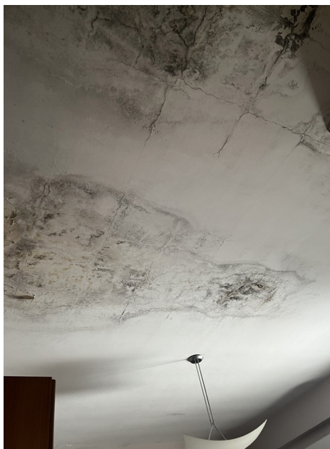
Foto 27 - Ammaloramento presente al secondo piano
