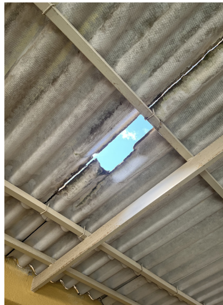
Foto 36 -Ammaloramento riscontrato nella copertura in ETERNIT
