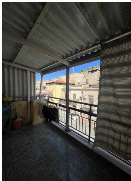
Foto 32 -Terrazza fronte Nord-Est avente copertura in ETERNIT
