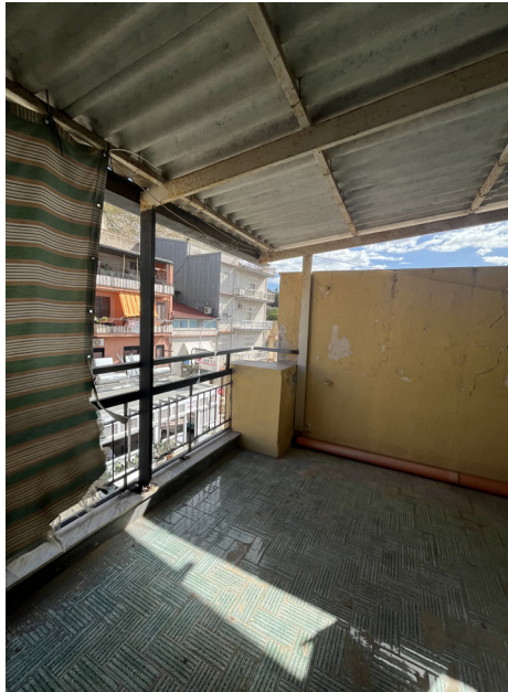
Foto 33 - Terrazza fronte Nord-Est avente copertura in ETERNIT
