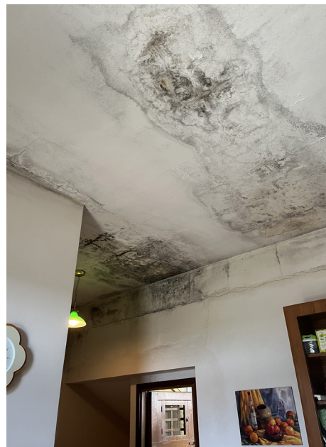
Foto 28 - Ammaloramento presente al secondo piano
