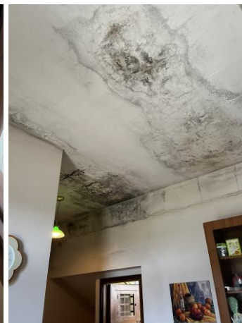
Foto 15-Ammaloramenti su intradosso di solaio piano secondo
