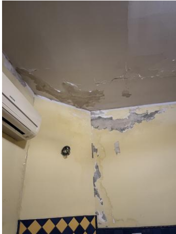
Foto 16-Ammaloramenti su intradosso di solaio piano primo- cucina
