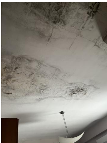
Foto 13-Ammaloramenti su intradosso di solaio al piano secondo
