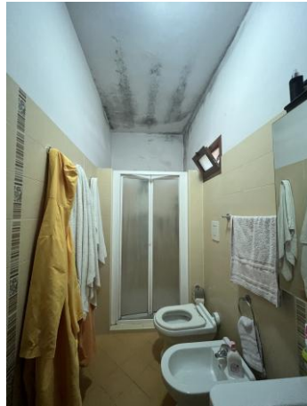
Foto 17-Ammaloramenti su intradosso di solaio piano primo- wc1
