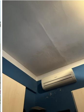
Foto 18-Ammaloramento su intradosso di solaio piano primo- Camera 2
