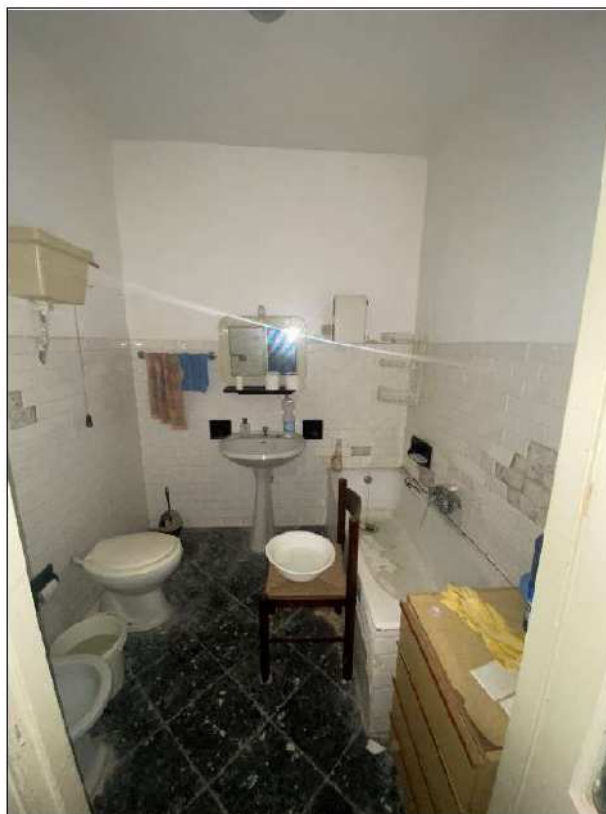
Foto n°5 – PT - Bagno non aerato con accesso diretto dalla cucina
