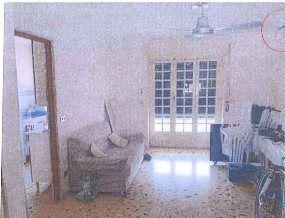
Foto n. 9 - Piano terra - zona pranzo soggiorno con annessa cucina (in prossimità del soffitto è possibile osservare la presenza di tracce di umidità da fenomeno infiltrativo proveniente dal terrazzo soprastante)
