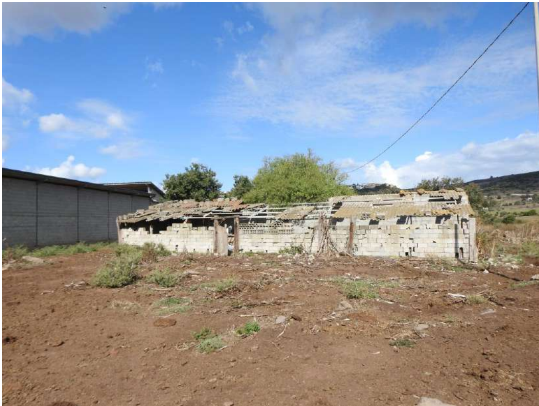
Figura 16 - Fabbricato H, tettoia pericolante ubicata in prossimità del fienile grande
