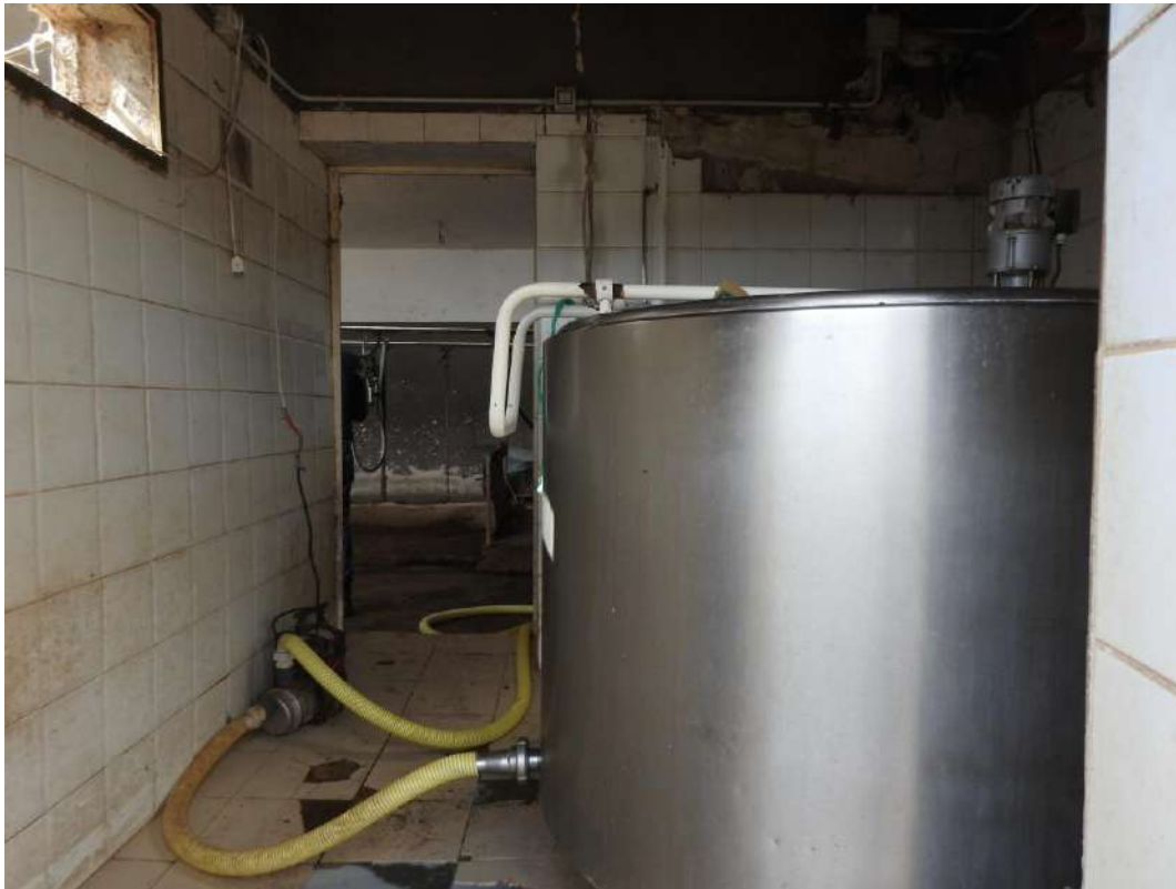
Figura 32 - Fabbricato A, minicaseificio. Foto interna sala vasca refrigerante
