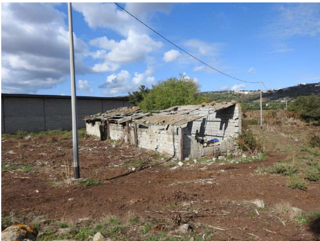
Figura 17 - Fabbricato H, tettoia pericolante ubicata in prossimità del fienile grande
