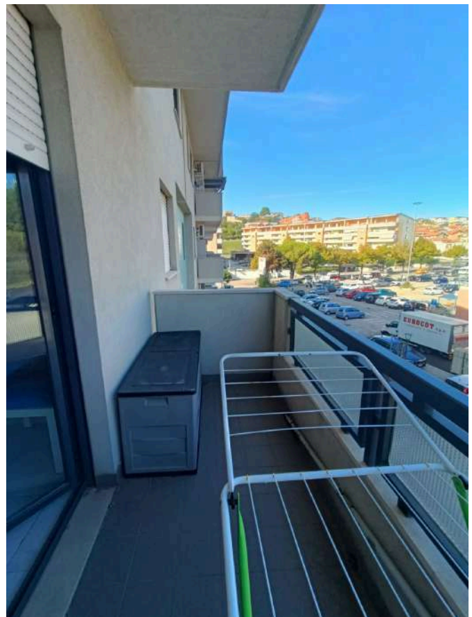
Stazione dei Carabinieri di Pescara Colli sita in Pescara al Largo Padre Alberto Mileno n.34, ai piani interrato, terra, primo, secondo, terzo e quarto, distinta al Catasto Fabbricati al Foglio n.11 Particella n.1935 Sub. n.106. PIANO SECONDO – LATO OVEST
