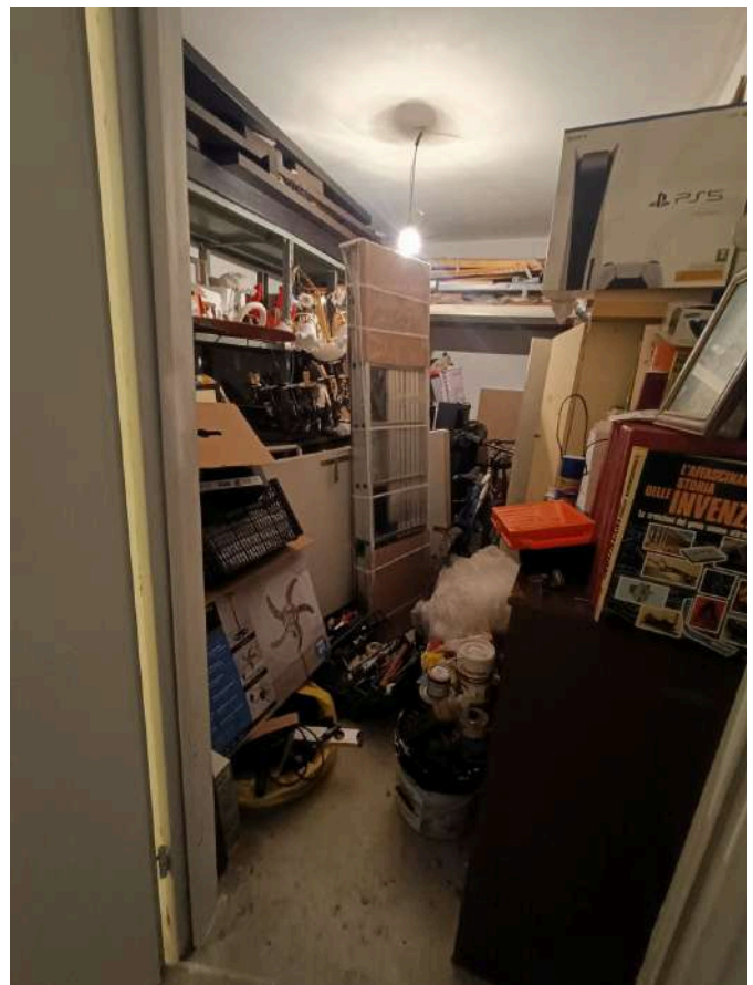
Stazione dei Carabinieri di Pescara Colli sita in Pescara al Largo Padre Alberto Mileno n.34, ai piani interrato, terra, primo, secondo, terzo e quarto, distinta al Catasto Fabbricati al Foglio n.11 Particella n.1935 Sub. n.106. PIANO INTERRATO – LATO OVEST
