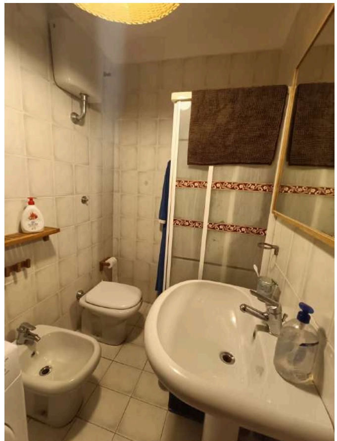
Stazione dei Carabinieri di Pescara Colli sita in Pescara al Largo Padre Alberto Mileno n.34, ai piani interrato, terra, primo, secondo, terzo e quarto, distinta al Catasto Fabbricati al Foglio n.11 Particella n.1935 Sub. n.106. PIANO TERZO – LATO EST
