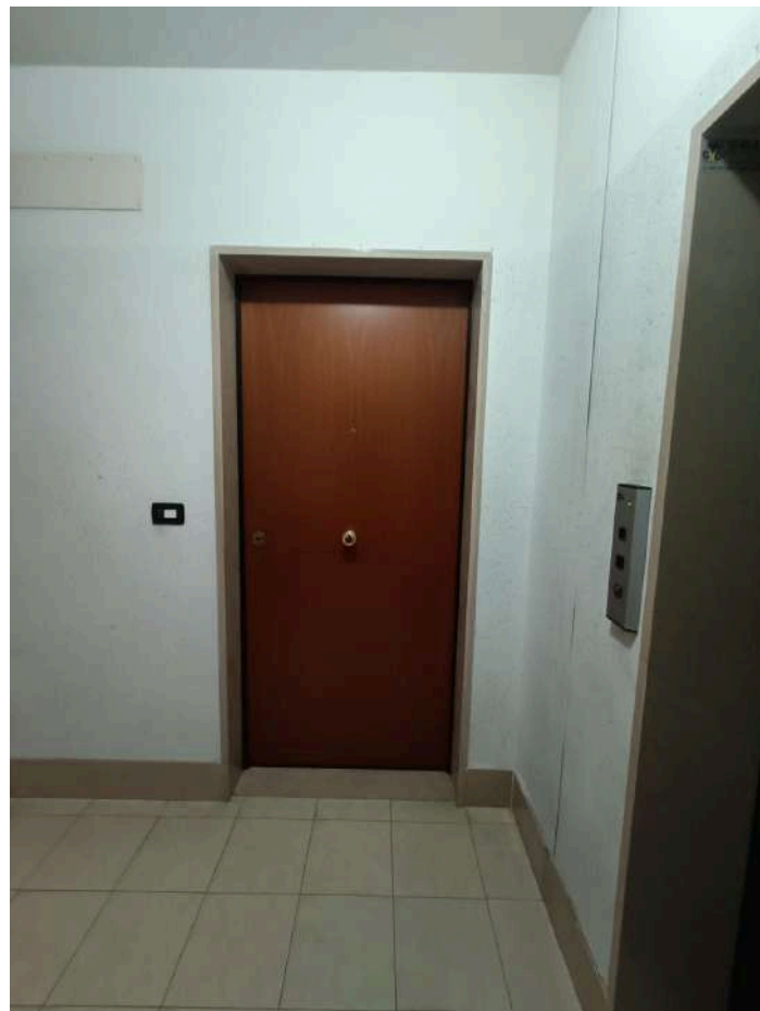
Stazione dei Carabinieri di Pescara Colli sita in Pescara al Largo Padre Alberto Mileno n.34, ai piani interrato, terra, primo, secondo, terzo e quarto, distinta al Catasto Fabbricati al Foglio n.11 Particella n.1935 Sub. n.106. PIANO QUARTO – VANO SCALA
