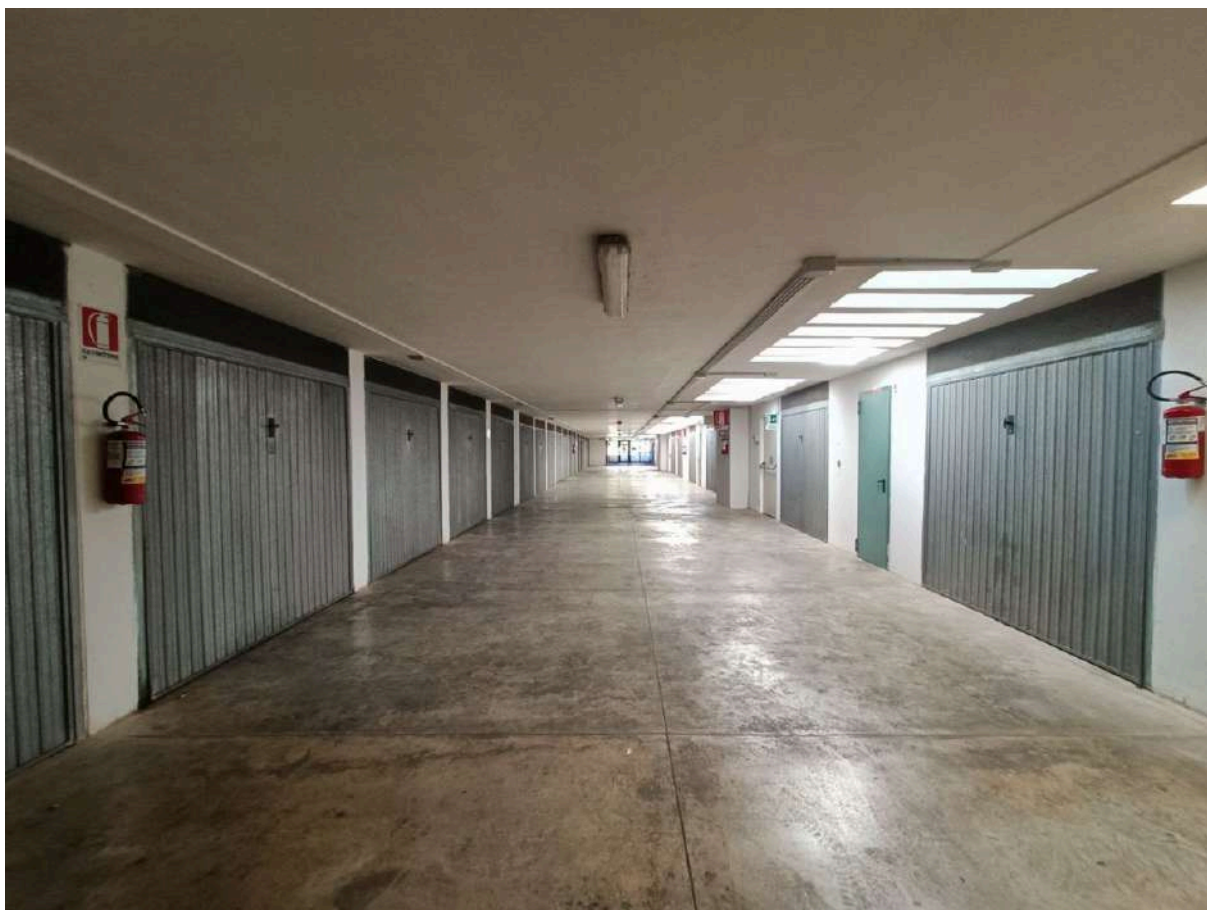
Fabbricato sito in Pescara al Largo Padre Alberto Mileno/Via di Sotto insistente su terreno distinto al Catasto Terreni al Foglio n.11 Particella n.1935. PIANO INTERRATO
