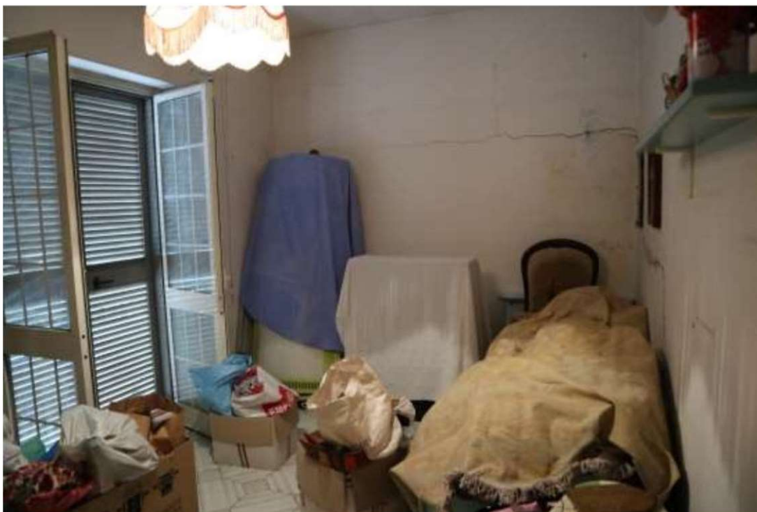
CAMERETTA CON LESIONI SULLE PARETI
