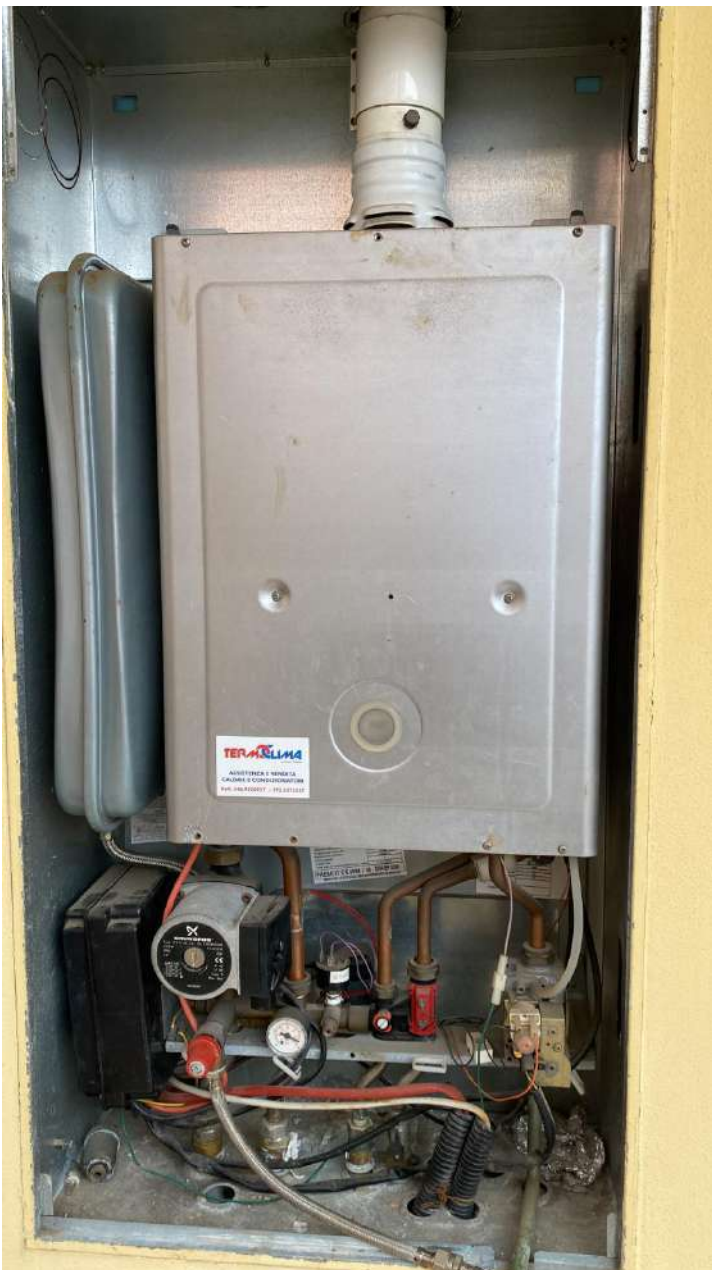
Foto 21 – caldaia “Hermann Spaziozero Basic 24 SE”
