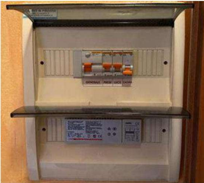
Foto 19 – quadro elettrico appartamento
