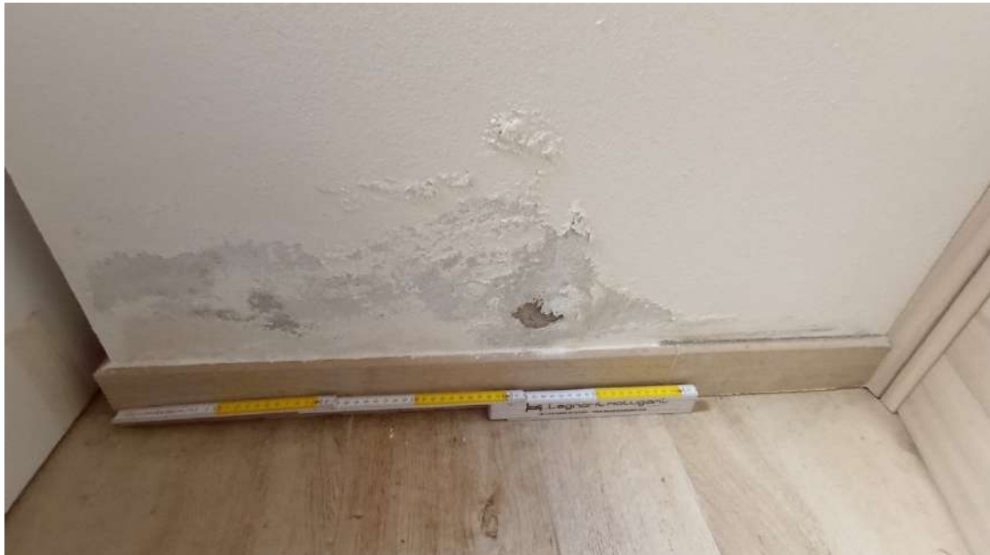
Immagine 26 - Infiltrazione di acqua sulla parete della "camera 1" in corrispondenza della doccia - Fonte: Sopralluogo in loco
