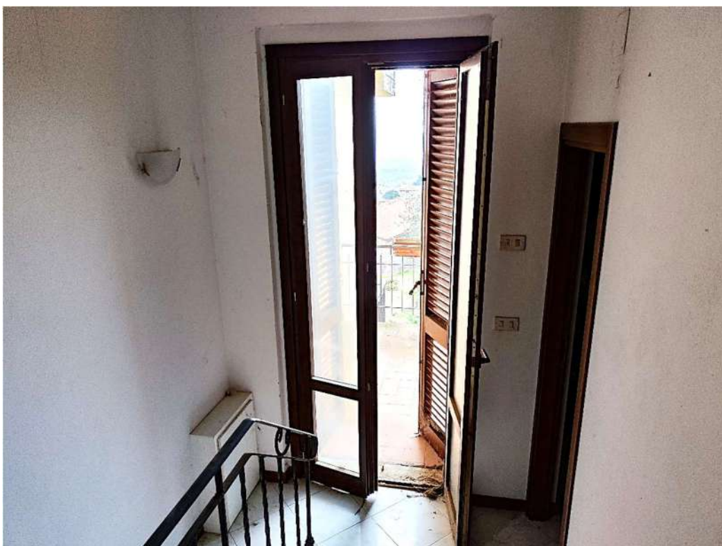
Foto 25 - Il pianerottolo tra piano terra e piano primo con l'accesso alla terrazza
