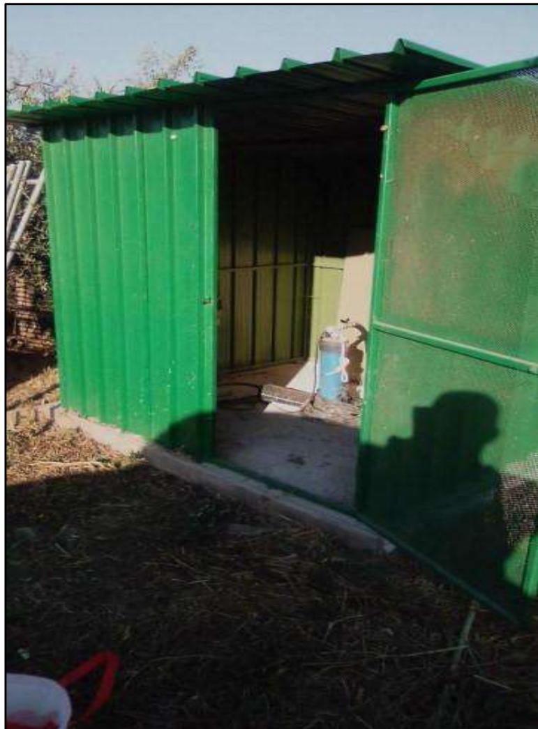
Foto 26 – pozzo con elettropompa ubicato sulla part.228
