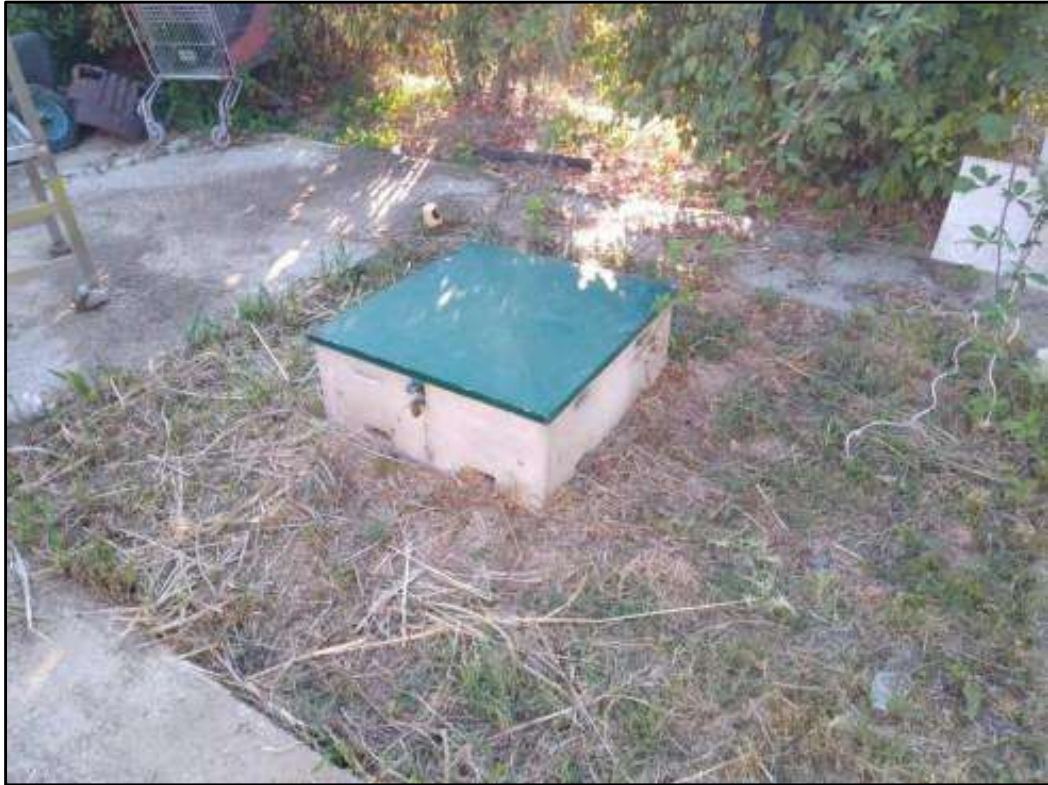
Foto 25 – gpl interrato ubicato sul resede della part.254
