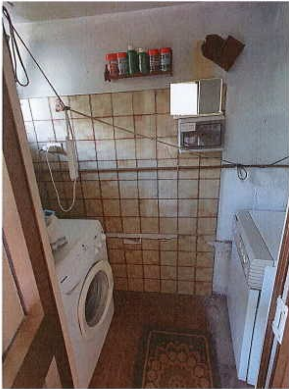
Interno Piano Terra – Cella Termica
