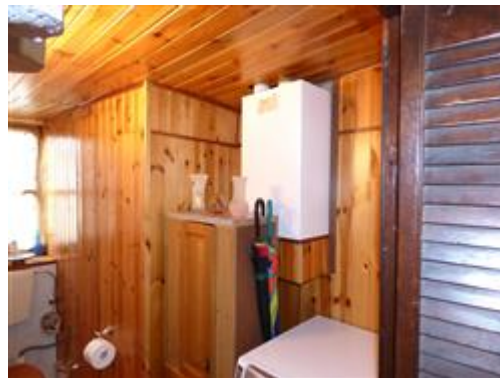
Caldaia produzione acqua calda
