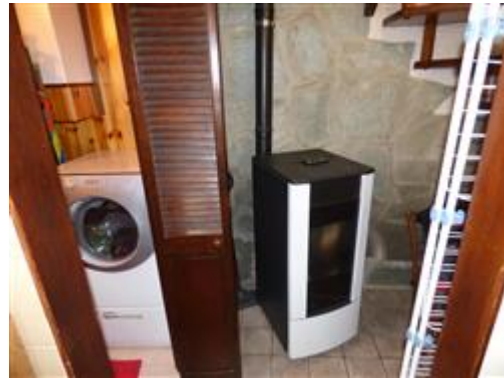
Caldaia a pellet
