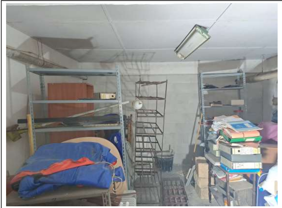
Foto n. 5 – Cantine / locali di deposito siti in Palermo, Via Palmerino n. 42, scala E, piano S1. Stato di fatto delle cantine (sub 90 e 91 rinvenuti fusi)
