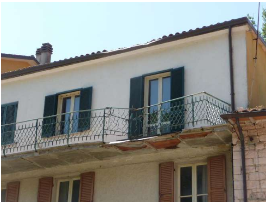
Foto n. 4 Particolare tetto e balcone danneggiati
