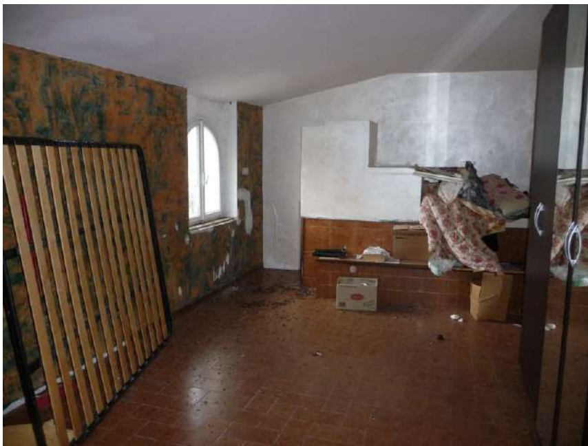
Foto n. 11 Locale su torretta P2
