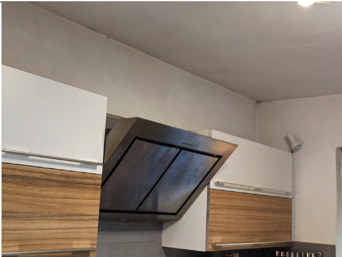
Foto 54 : dettagli - degrado per umidità nel soffitto della cucina
