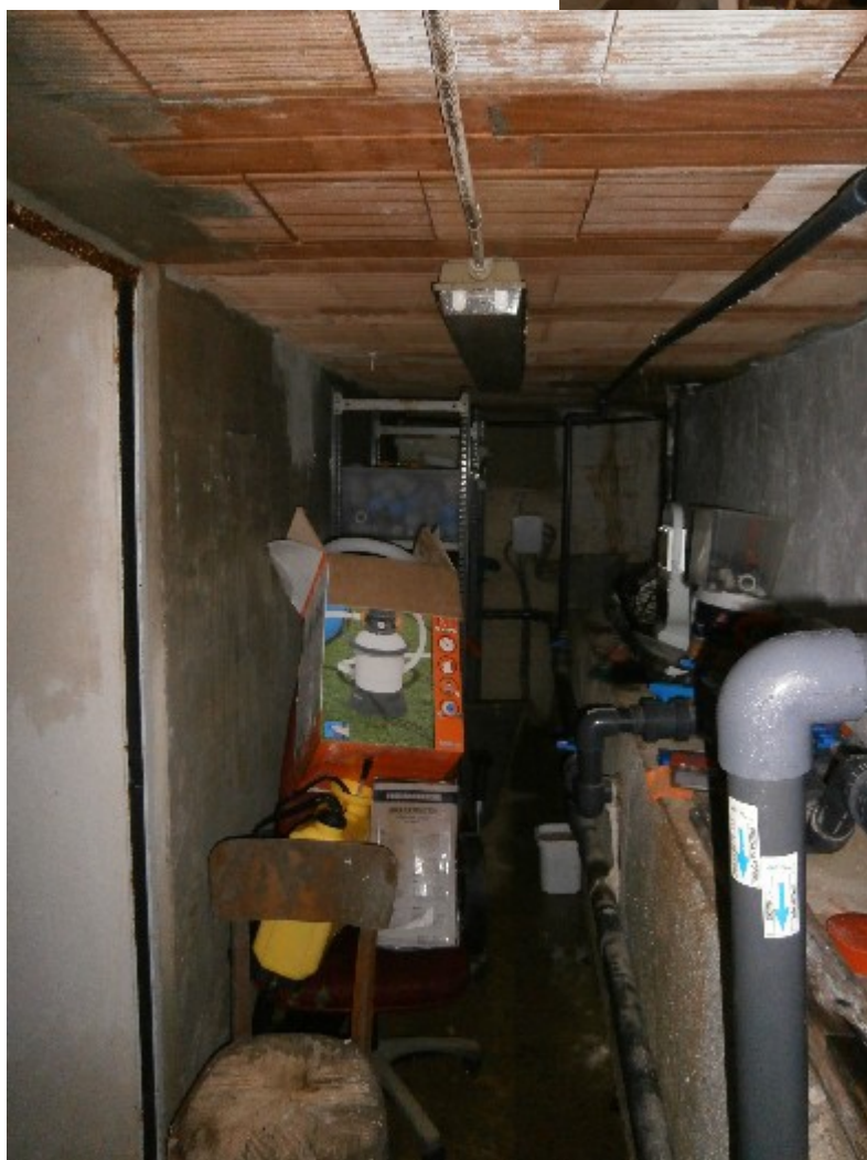
Foto 46: Volume tecnico zona macchinari
