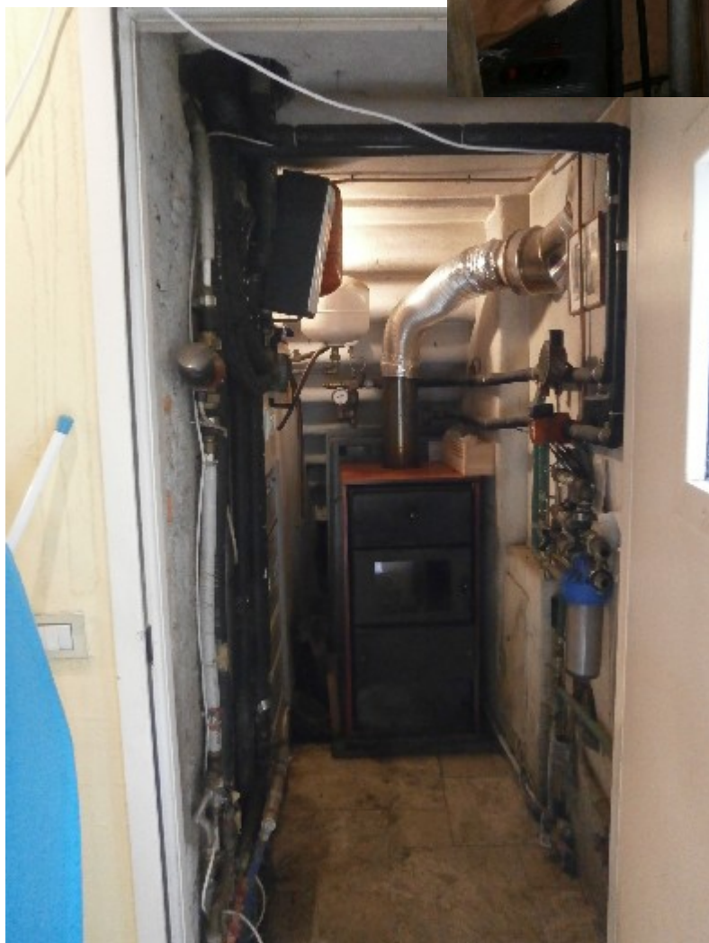
Foto 16: Sottoscala con caldaia a legna
