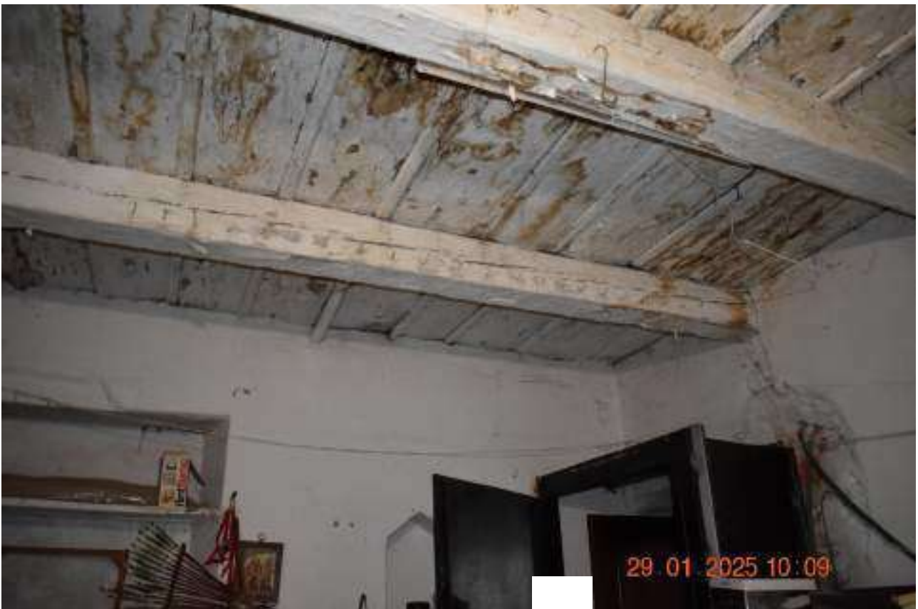
FOTO N.46: Vano, non utilizzato dai proprietari per le precarie condizioni del tavolato del soffitto dove sono visibili diffuse infiltrazioni e ubicato al piano terra dell'appartamento
