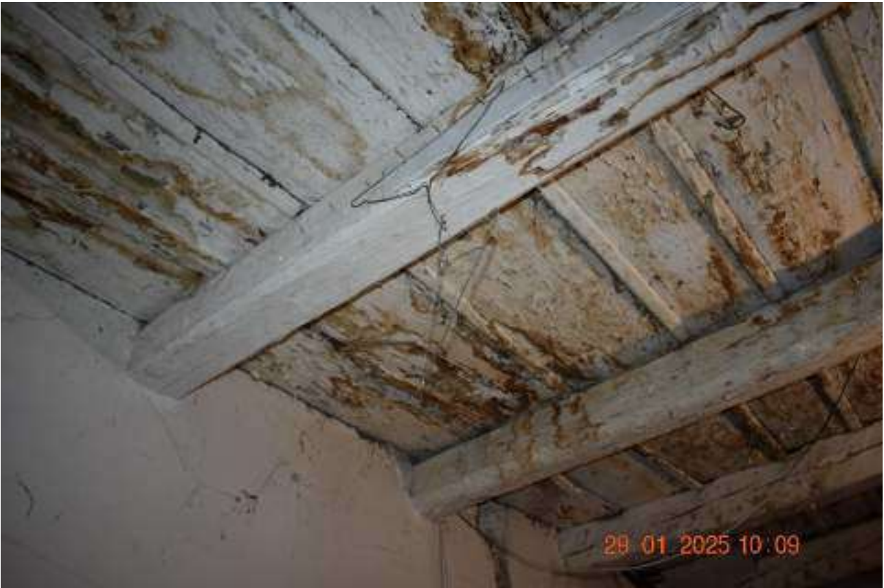
FOTO N.47: Vano, non utilizzato dai proprietari per le precarie condizioni del tavolato del soffitto dove sono visibili diffuse infiltrazioni e ubicato al piano terra dell'appartamento.
