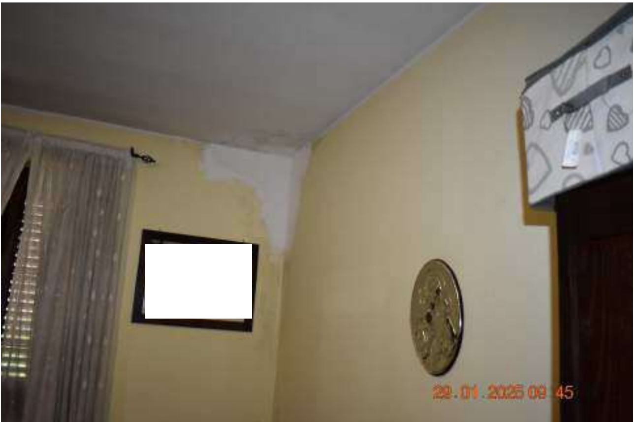
FOTO N.10: Camera da letto matrimoniale. Sono visibili i danni da infiltrazioni.
