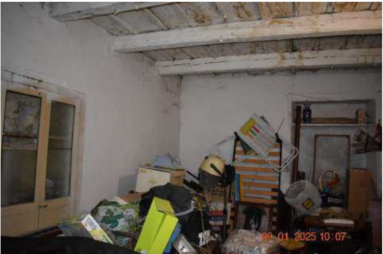
FOTO N.36: Vano, non utilizzato dai proprietari per le precarie condizioni del tavolato del soffitto dove sono visibili diffuse infiltrazioni e ubicato al piano dell'appartamento.
