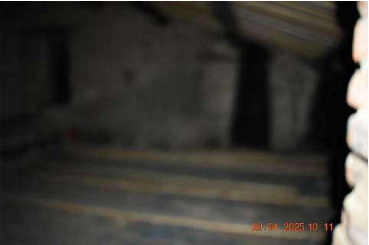
FOTO N.49: Il piano primo dell'appartamento consiste in una soffitta con un precario tavolato. L'accesso al piano primo avviene da una scala precaria.
