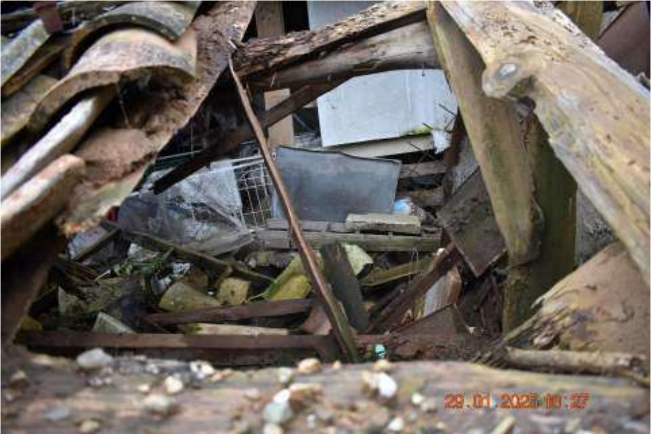
FOTO N.87: La tettoia identificata con la particella 1188. Particolare del tetto crollato
