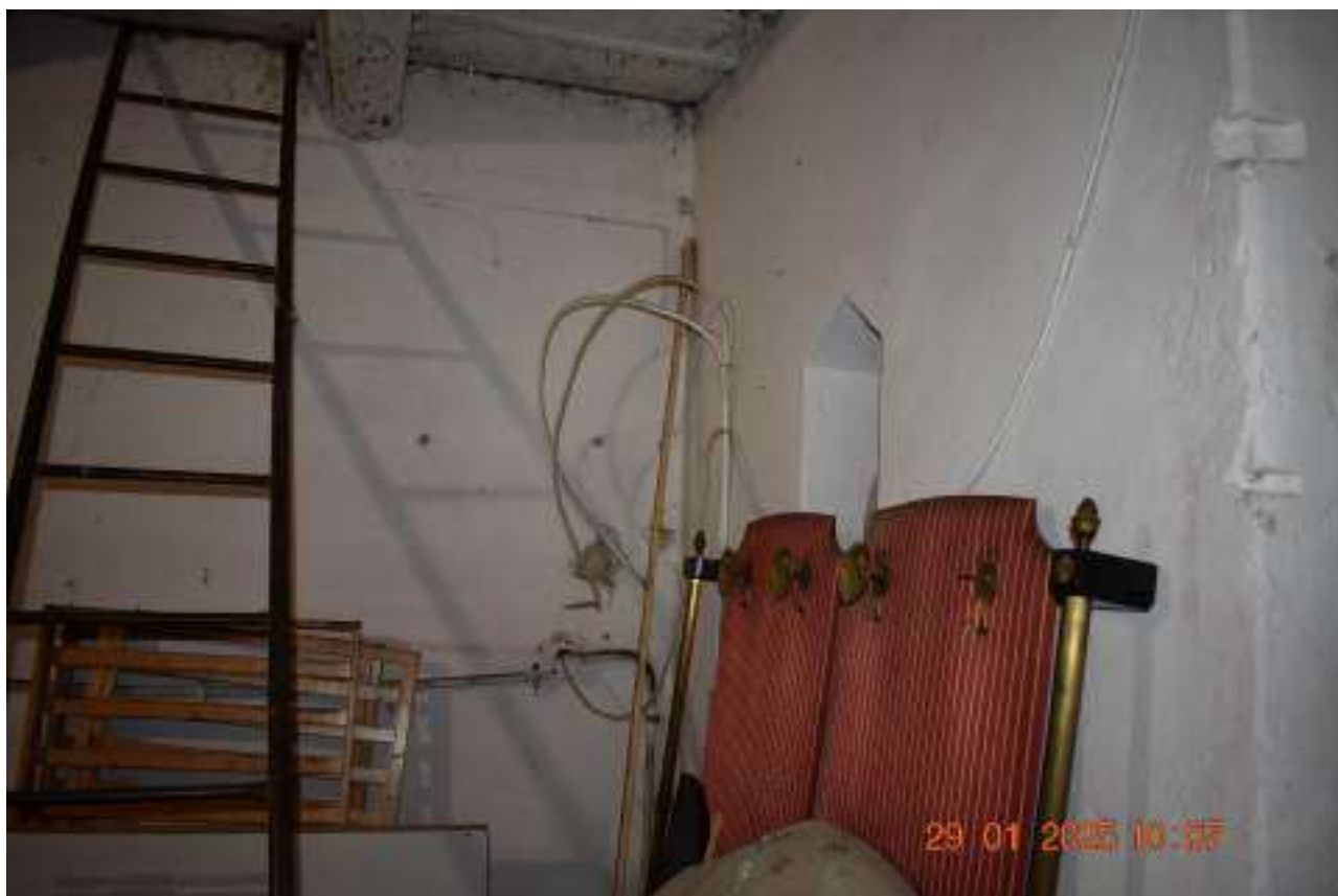
FOTO N.38: Vano, non utilizzato dai proprietari per le precarie condizioni del tavolato del soffitto dove sono visibili diffuse infiltrazioni e ubicato al piano dell'appartamento. L'accesso al piano primo avviene da una scala in ferro precaria.
