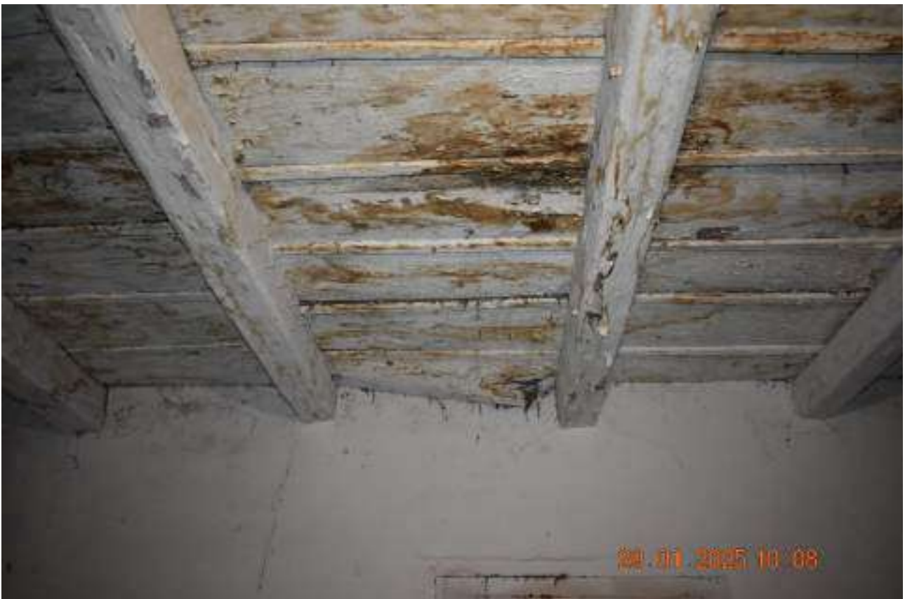
FOTO N.42: Vano, non utilizzato dai proprietari per le precarie condizioni del tavolato del soffitto dove sono visibili diffuse infiltrazioni e ubicato al piano terra dell'appartamento.
