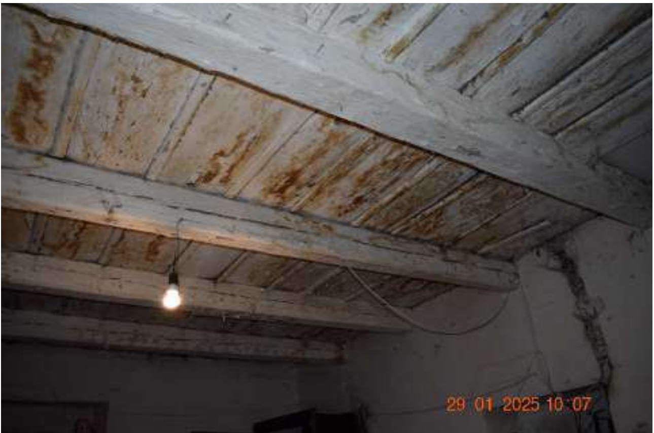
FOTO N.40: Vano, non utilizzato dai proprietari per le precarie condizioni del tavolato del soffitto dove sono visibili diffuse infiltrazioni e ubicato al piano dell'appartamento.
