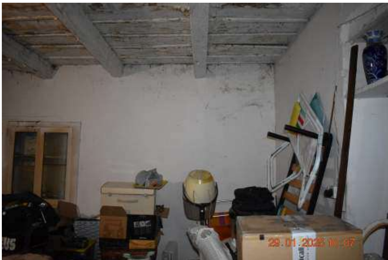
FOTO N.34: Vano deposito, non utilizzato dai proprietari per le precarie condizioni del tavolato del soffitto dove sono visibili diffuse infiltrazioni e ubicato al piano dell'appartamento.
