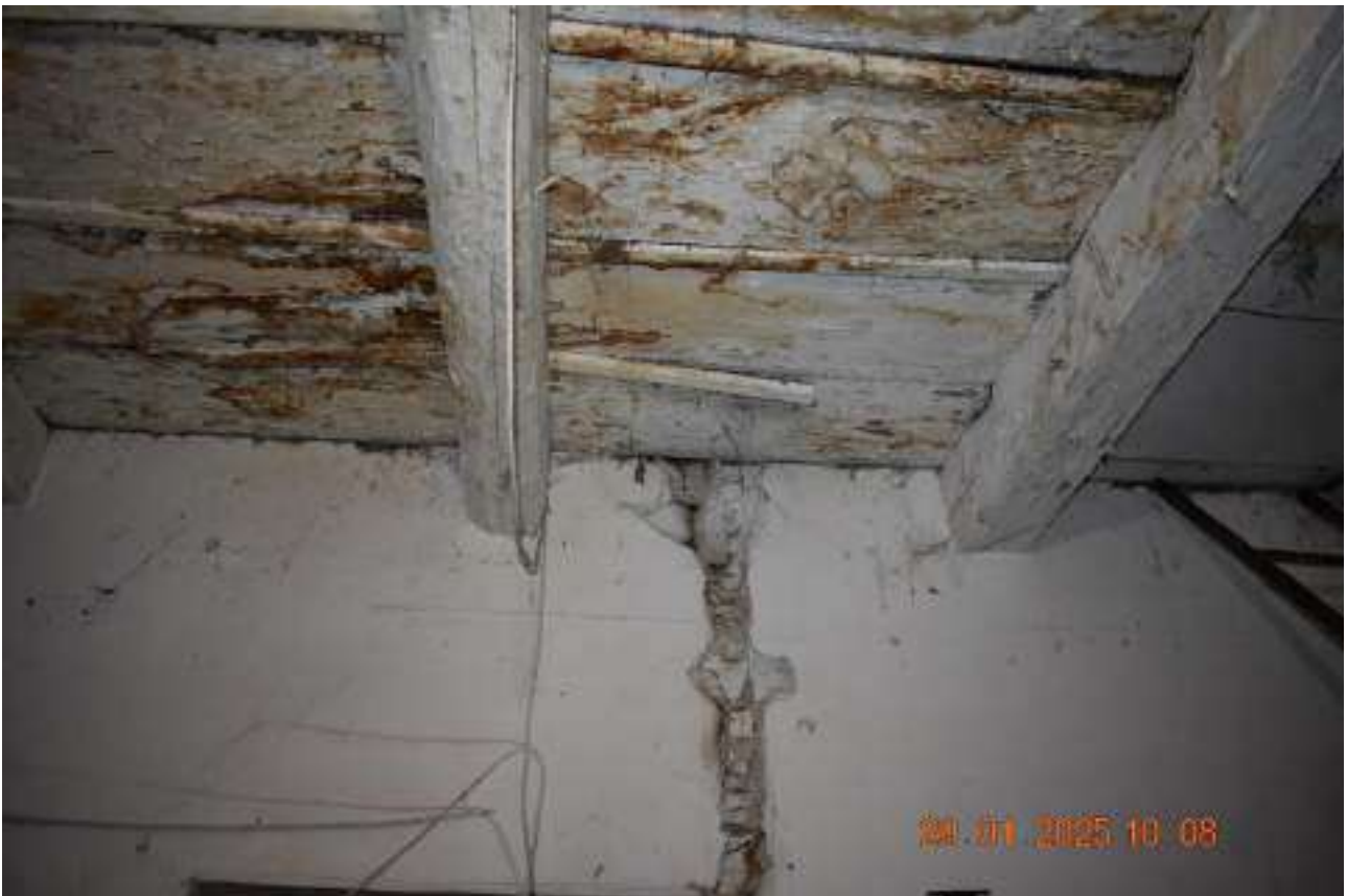
FOTO N.41: Vano, non utilizzato dai proprietari per le precarie condizioni del tavolato del soffitto dove sono visibili diffuse infiltrazioni e ubicato al piano terra dell'appartamento
