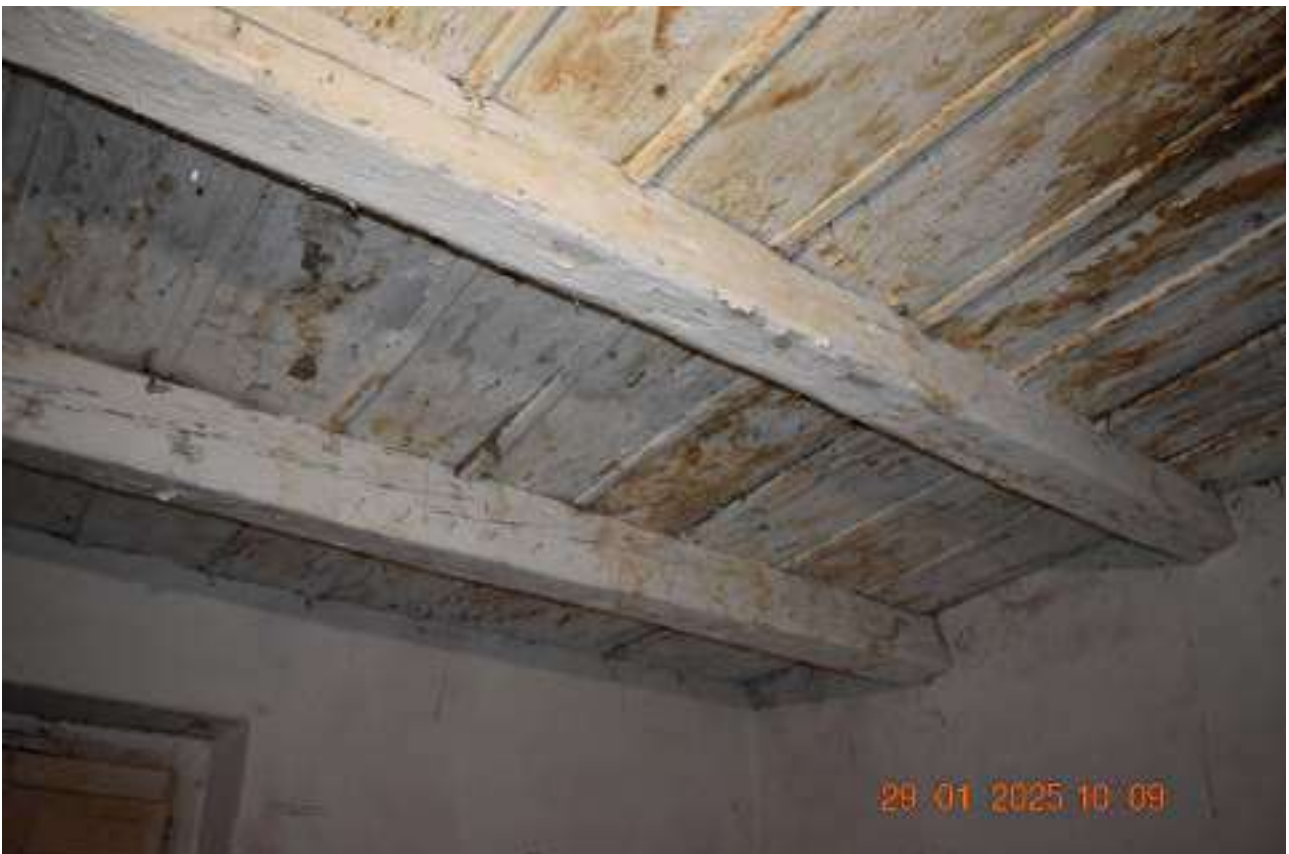
FOTO N.44: Vano, non utilizzato dai proprietari per le precarie condizioni del tavolato del soffitto dove sono visibili diffuse infiltrazioni e ubicato al piano terra dell'appartamento.
