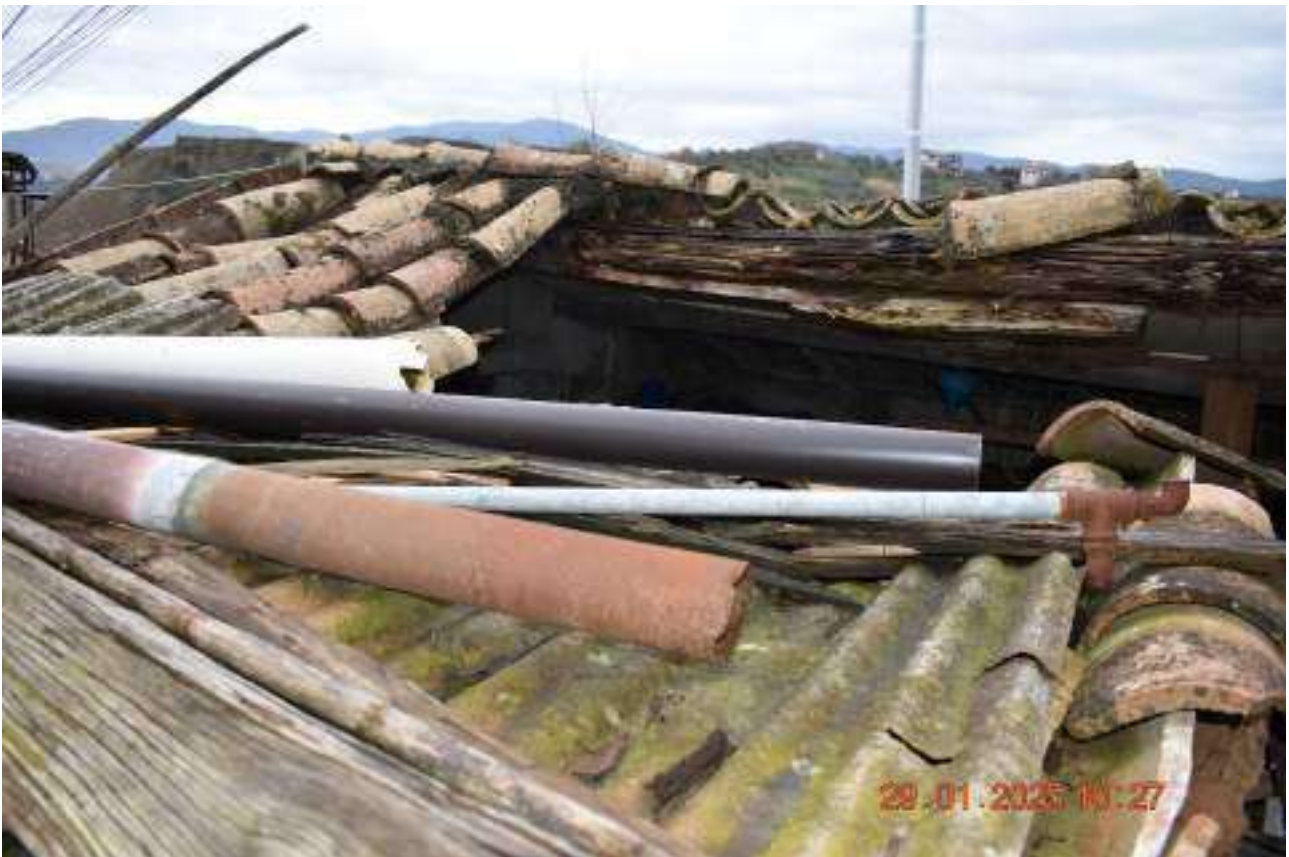
FOTO N.86: La tettoia identificata con la particella 1188. Particolare del tetto crollato
