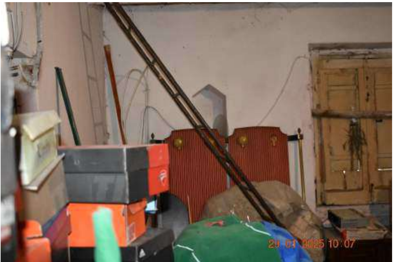
FOTO N.32: Vano deposito, non utilizzato dai proprietari, per le infiltrazioni presenti e ubicato al piano dell'appartamento
