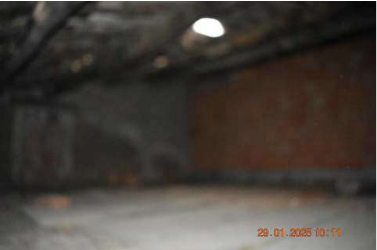
FOTO N.48: Il piano primo dell'appartamento consiste in una soffitta con un tavolato intriso dalle infiltrazioni. L'accesso al tavolato avviene da una scala precaria.
