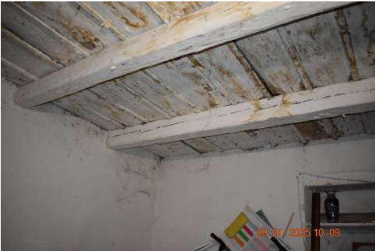
FOTO N.45: Vano, non utilizzato dai proprietari per le precarie condizioni del tavolato del soffitto dove sono visibili diffuse infiltrazioni e ubicato al piano terra dell'appartamento.
