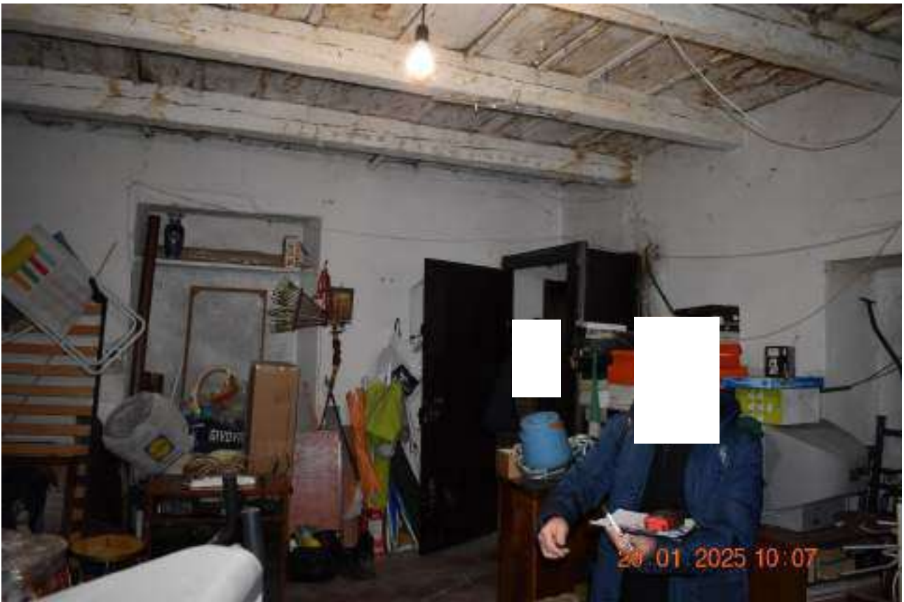
FOTO N.35: Vano, non utilizzato dai proprietari per le precarie condizioni del tavolato del soffitto dove sono visibili diffuse infiltrazioni e ubicato al piano dell'appartamento.
