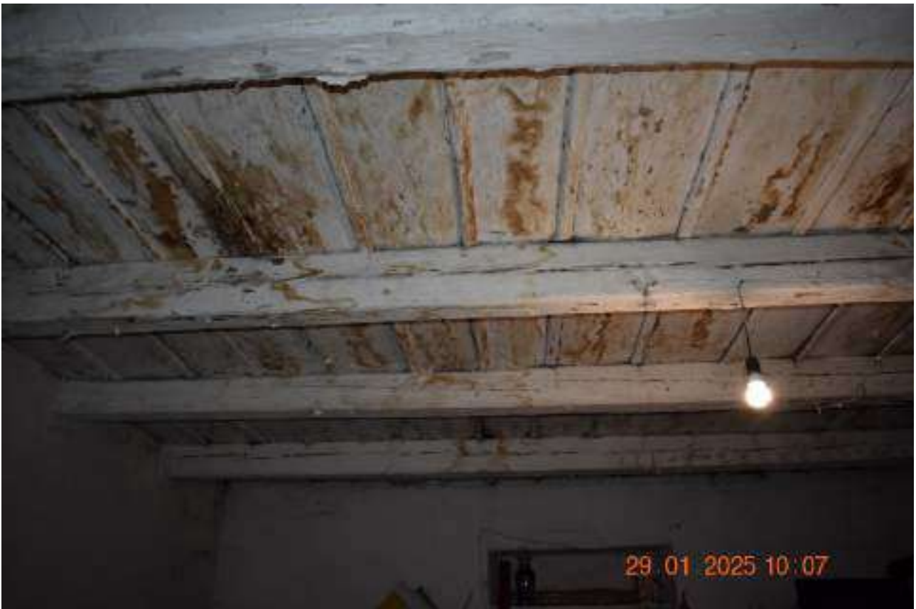
FOTO N.39: Vano, non utilizzato dai proprietari per le precarie condizioni del tavolato del soffitto dove sono visibili diffuse infiltrazioni e ubicato al piano dell'appartamento.
