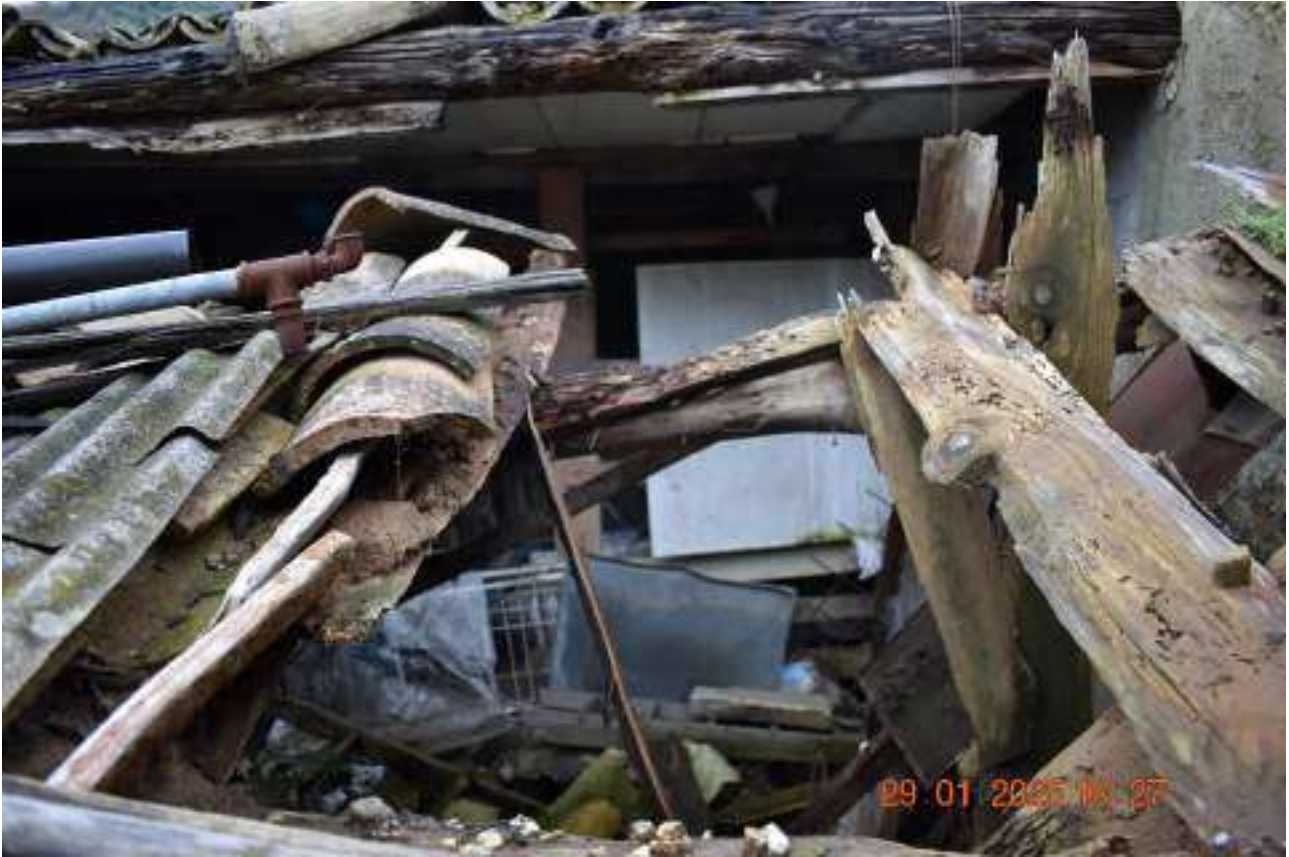
FOTO N.85: La tettoia identificata con la particella 1188. Particolare del tetto crollato
