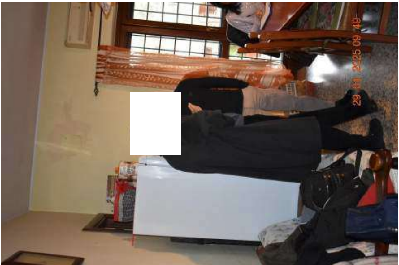
FOTO N.20: Cucina. Si notano infiltrazioni sulla parete
