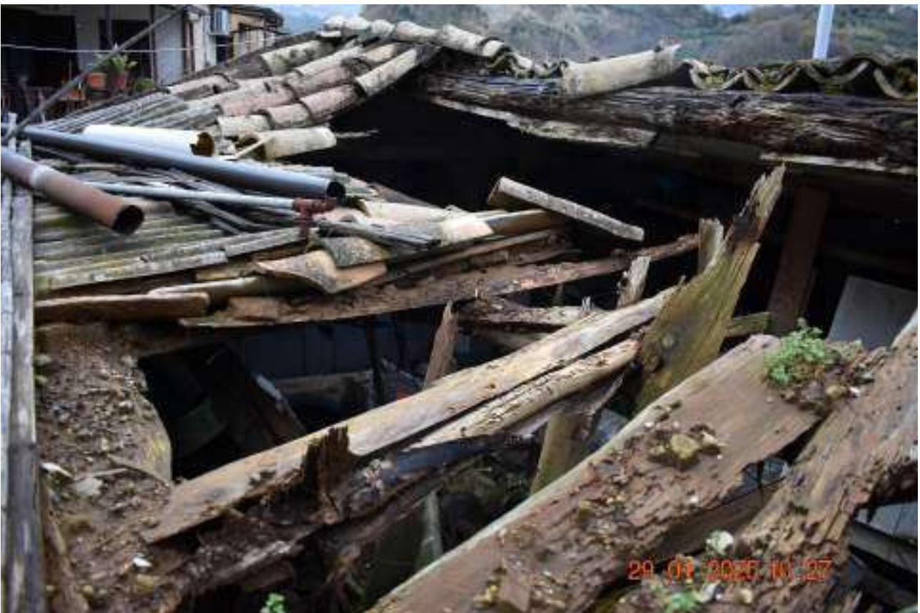
FOTO N.88: La tettoia identificata con la particella 1188. Particolare del tetto crollato
