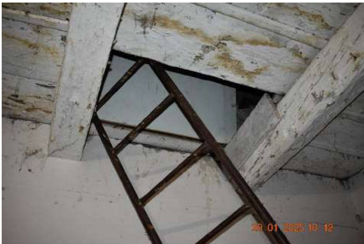
FOTO N.51: Vano, non utilizzato dai proprietari per le precarie condizioni del tavolato del soffitto dove sono visibili diffuse infiltrazioni e ubicato al piano terra dell'appartamento. L'accesso al piano primo avviene da una scala precaria.
